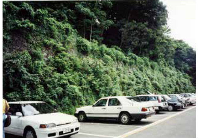
写真1 草木に覆われた石垣（平成3年）
