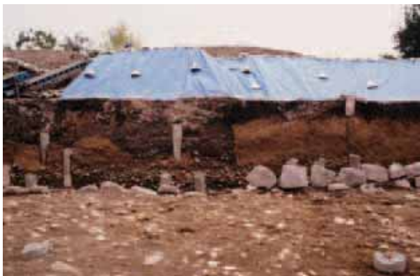
内堀東部北岸（三ノ丸南面石垣 2230S） 6
