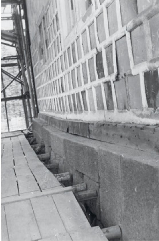
⑧石川櫓（南側） 石垣の沈下箇所
