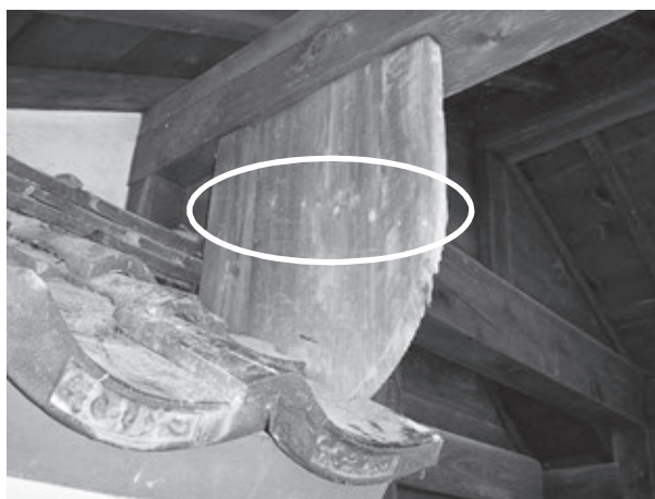
柄振板の鉛の腐食痕跡と鉛板を留めていた釘痕
