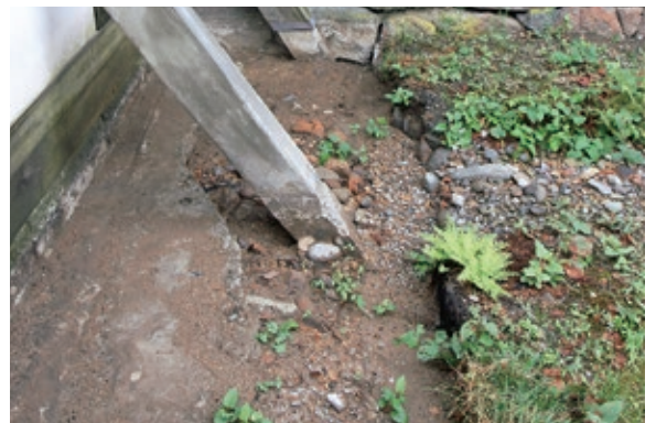
昭和修理コンクリート製土間破損状況（調査前） 北から
