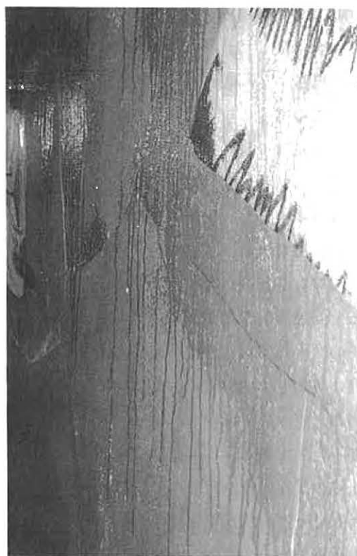
図3. 施設壁面の結露の様子
