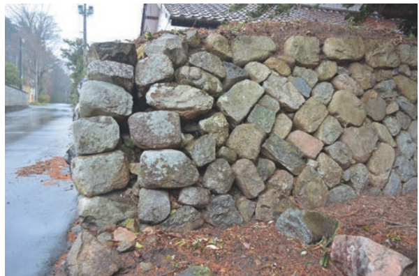
写真4 宮城県沖地震被害状況（北面）
