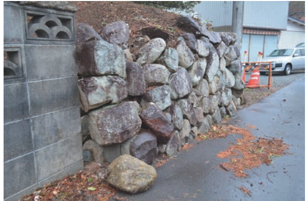
写真2 宮城県沖地震被害状況（東面）
