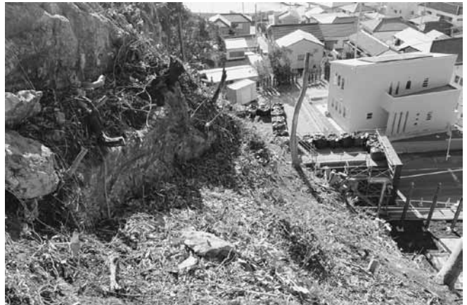
(6) 西斜面上部崩落箇所 (北から)
