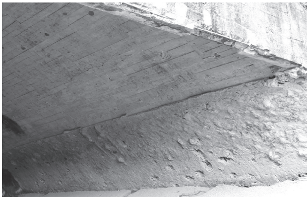
5. 掩体内部側壁に残る被弾痕跡 機銃掃射や爆弾の炸裂の痕跡と考えられる
