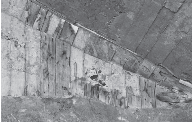
1. 前部奥壁と天井の接続部 型枠の板材が部分的に残存する
