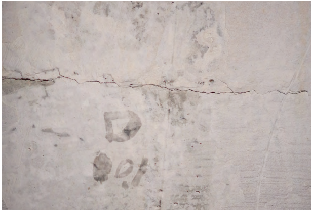
③ 第1砲側庫跡 クラック調査3
