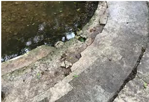
② 第2砲座跡砲座コンクリート剥離面
