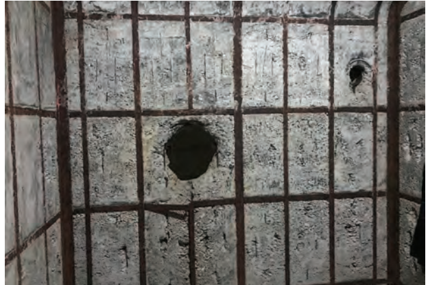
④ 第2弾薬庫跡 内庫前室の孔
