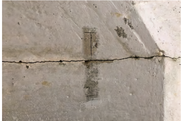
④ 第1砲側庫跡 クラック調査4
