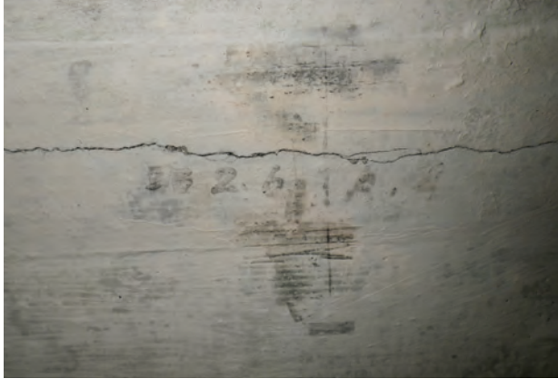
① 第1砲側庫跡 クラック調査1
