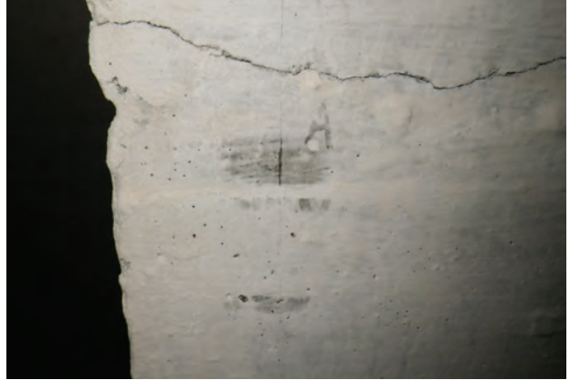
② 第1砲側庫跡 クラック調査2
