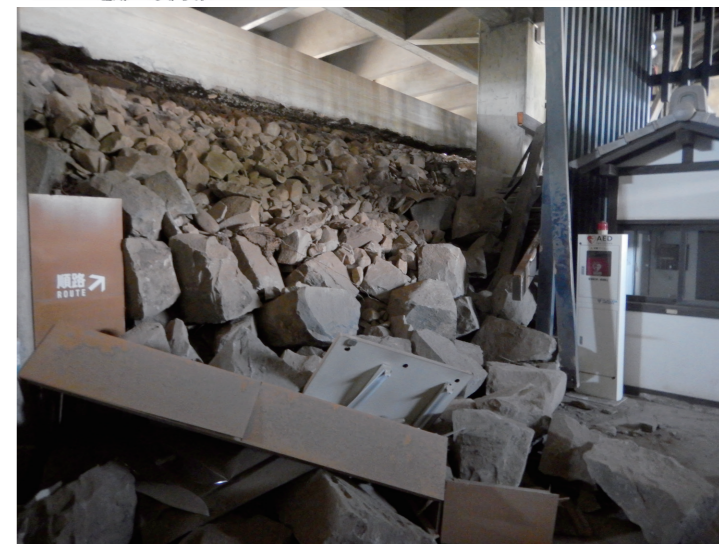
小天守穴蔵石垣崩落状況
