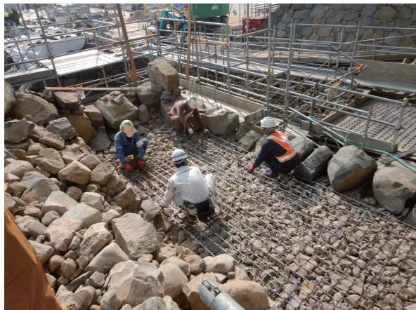
⑦ 積み直し作業（石垣内部構造補強：現代工法） 小天守入口付近の来場者導線の安全が確保できない箇所のみ、明治時代以降に積み直されている範囲に限り、石垣内部に補強材を敷き込みました。
