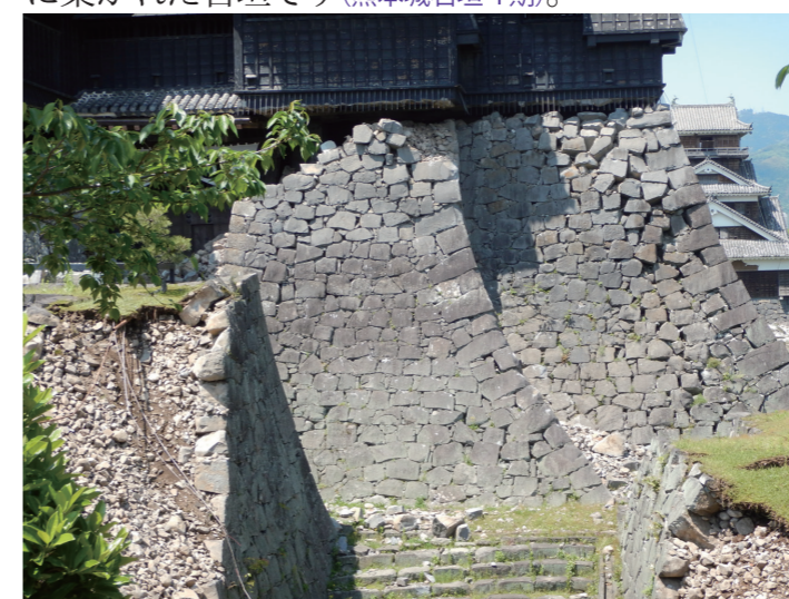
小天守石垣東面(H509・H511)被害状況(東から)
