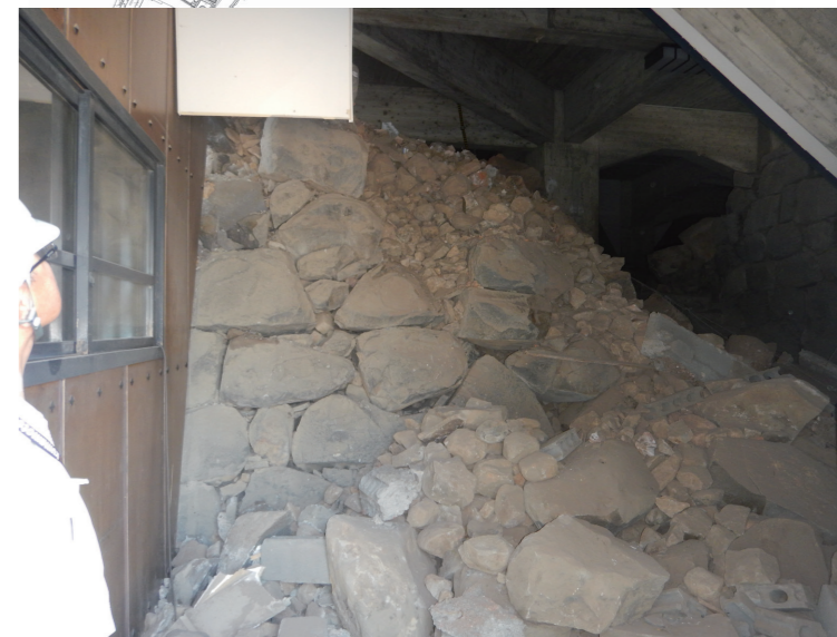
大天守穴蔵石垣崩落状況
