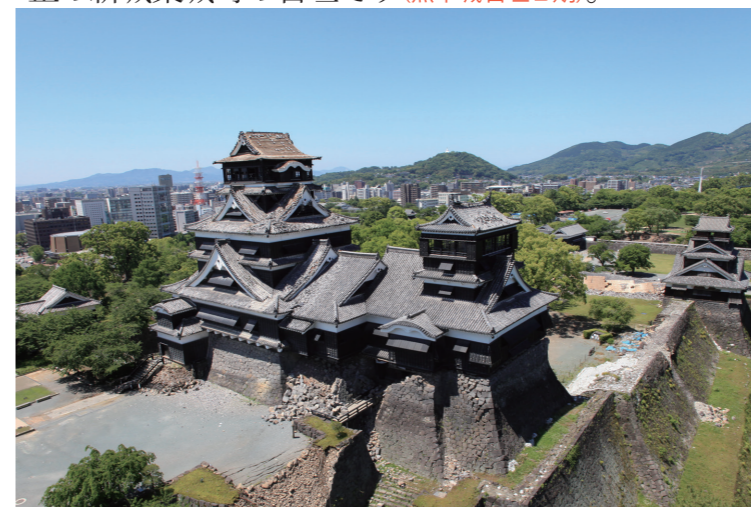
大小天守石垣被害状況（東北東から）
