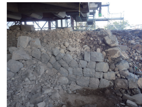
通路東側面石垣
