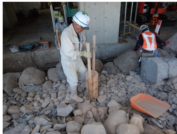
⑦ 積み直し作業（裏込め） 裏込めもすべて手作業で施工します。
