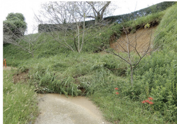
本丸の斜面崩落状況
