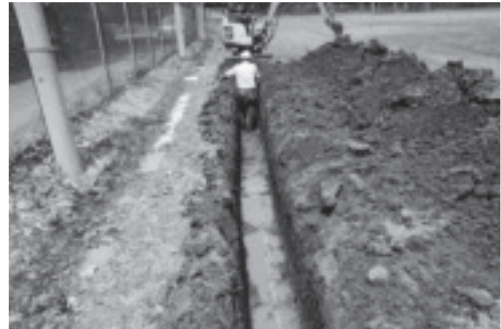
D. 札幌団地基幹整備（学寮地区給水設備）工事（南東より）調査番号：2105
