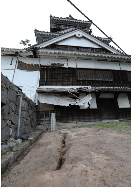
地表面で確認できる熊本地震の影響
