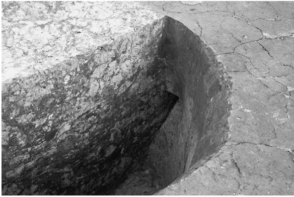
77SK2 壁面抉れ部 (北西から)
