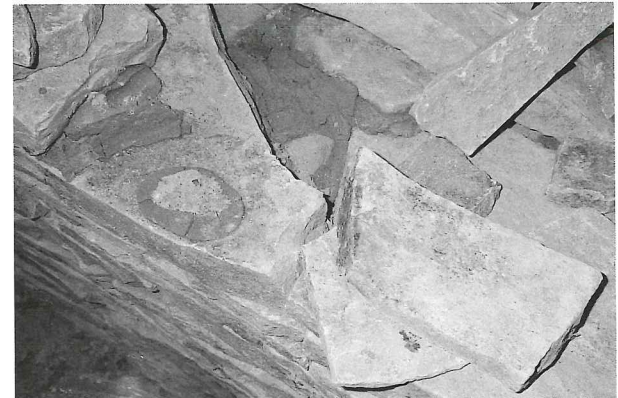
6. 接着した石材の剥離
