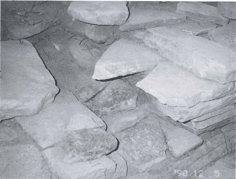
割れた基底部石材
