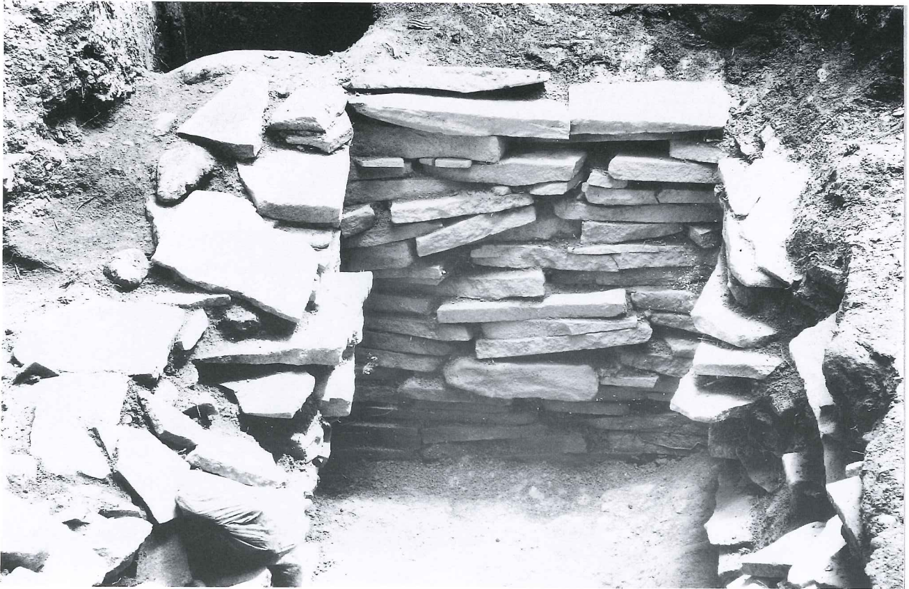
修復前の東短側壁
