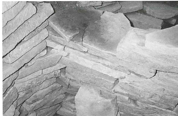
5. 割れた石材（北長側壁西隅）
