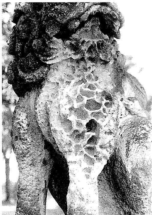
写真81 別宮社狛犬 劣化部
