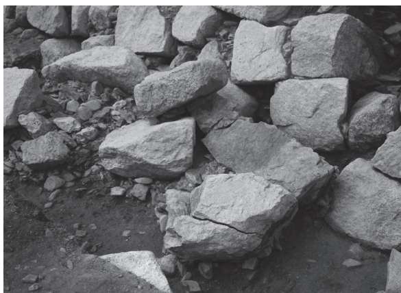
5 4区崩落石(南東から)
