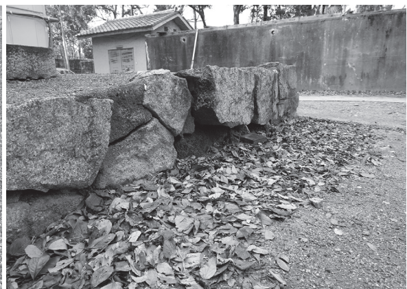
図 64 基壇石の孕み（南東から）
