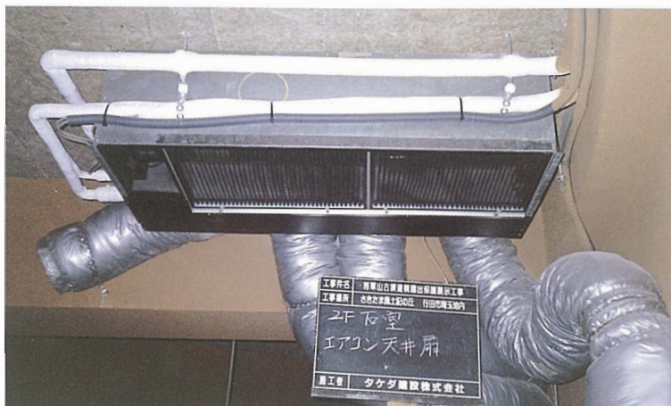
石室内エアコン設置状況
