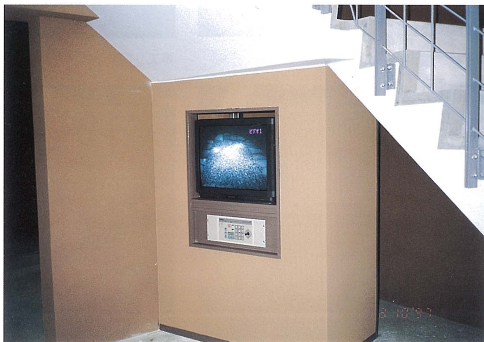
モニターテレビ設置状況
