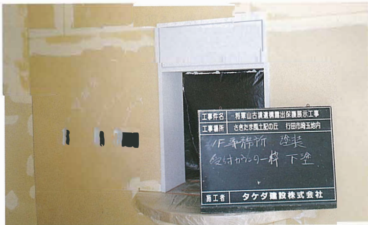
受付カウンター枠（1階事務所）
