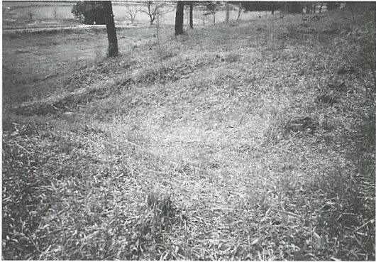
第67図版 くびれ部付近の崩落状況
