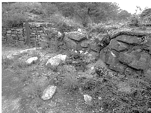
第96図版 落石状況（北東から）
