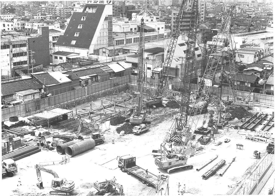
1 調査地全景（写真中央がA地区、その他が調査前のB地区）
