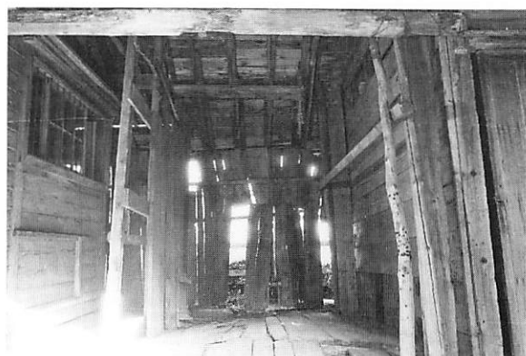
4 修理前 取合部 左便所、右物置
