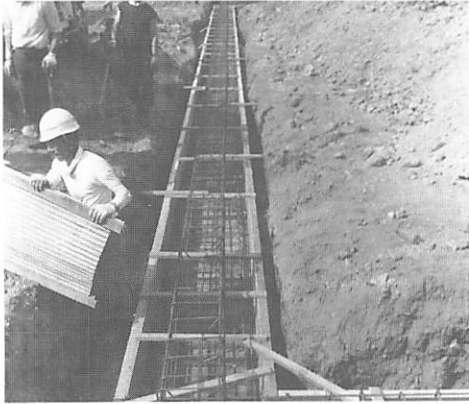
1 基礎工事 地下遺構を撤去してコンクリート基礎を設けた
