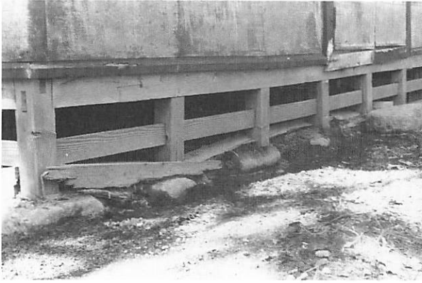
1 修理前 基礎、柱根廻り破損状況
