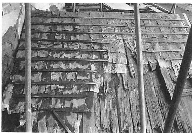
4 解体中 前室屋根土居葺破損状況
