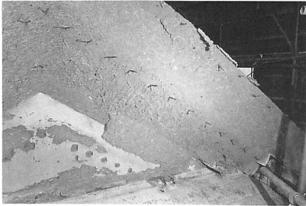
1 修理前 妻部土壁破損状況
