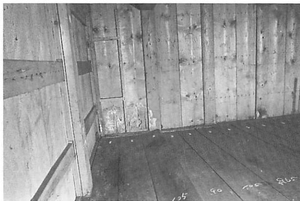
木部の破損状況
