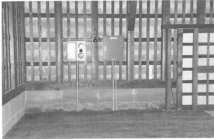
図31 石蔵 設備関係盤の設置状況
