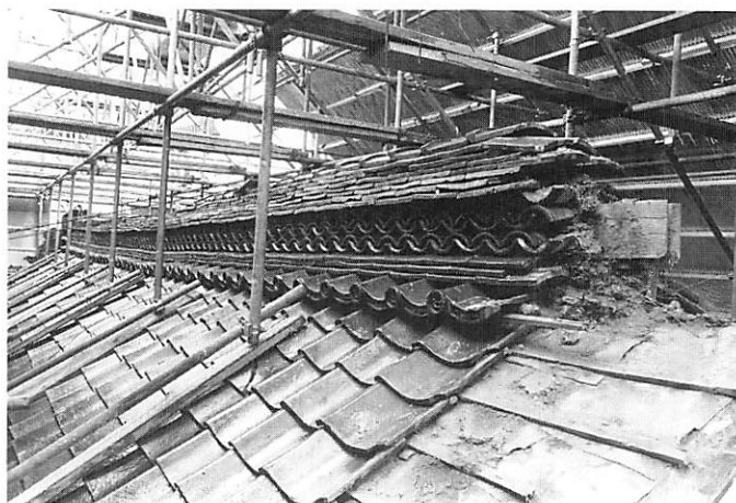
3 修理前 屋根・棟積破損状況
