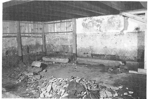
図15 文書倉 地階破損状況
