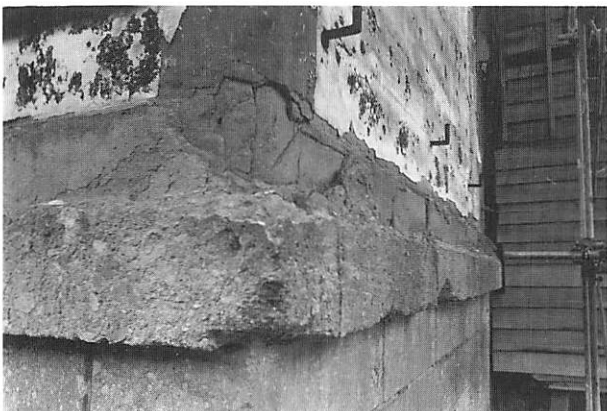
5 修理前 腰部土壁破損状況
