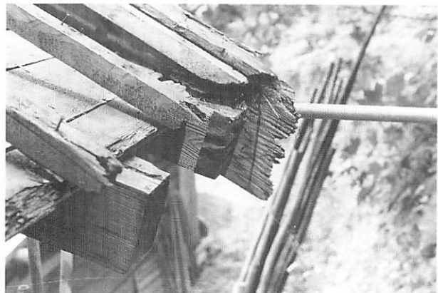
3 解体中 軒先妻部分の腐朽
