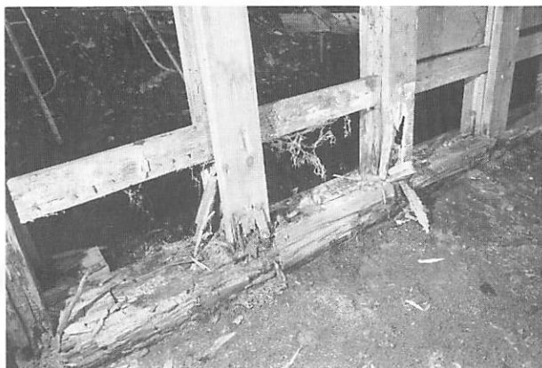
3 解体中 土台・柱根腐朽状況
