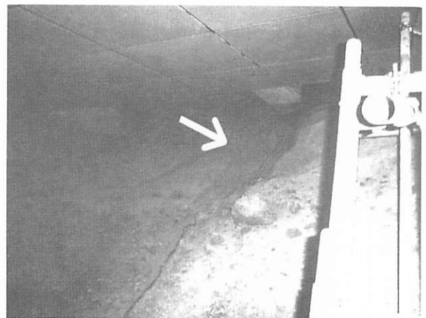
写真5 夏季に見られた漏水（平成15年9月）
