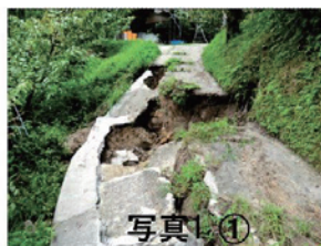
2020.7.28 大雨による 禪定院跡の崩れ1
