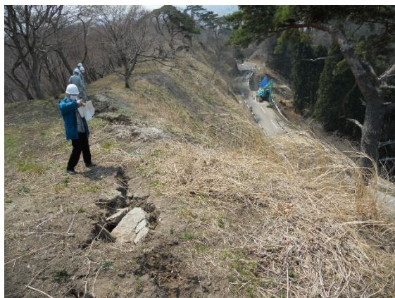
第 2 図 史跡岩切城跡の被災状況
