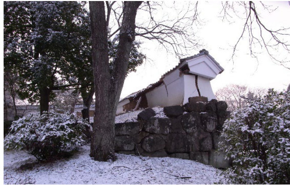
第 15 図 大手門北側土塀の被災状況 (2)
