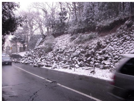
第9図 本丸北西石垣の崩落状況(2)
