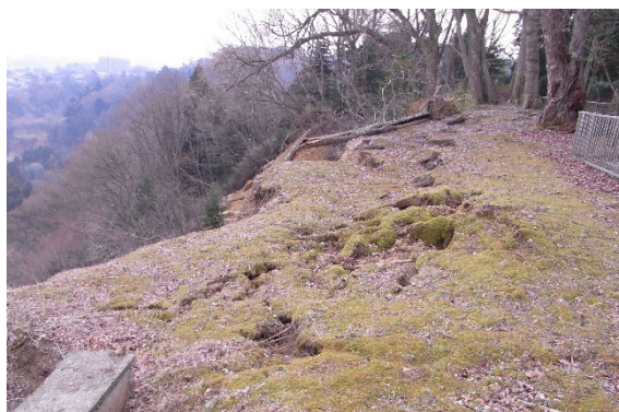
第12図 本丸東側崖面の被災状況
