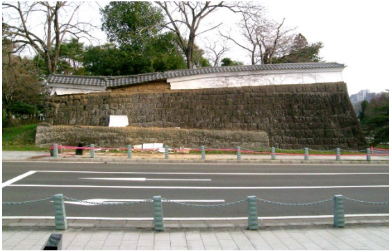
第 14 図 大手門北側土塀の被災状況 (1)
