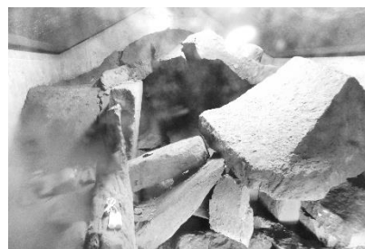
図2 塚原古墳群石之室古墳被災状況
