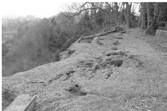
第12図 本丸東側崖面の被災状況
