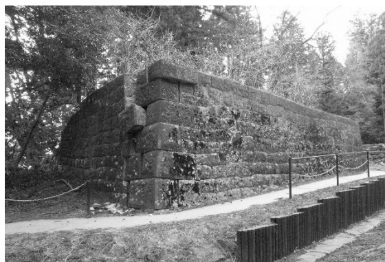
第11図 中門石垣の被災状況
