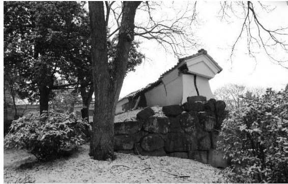
第 15 図 大手門北側土塀の被災状況 (2)
