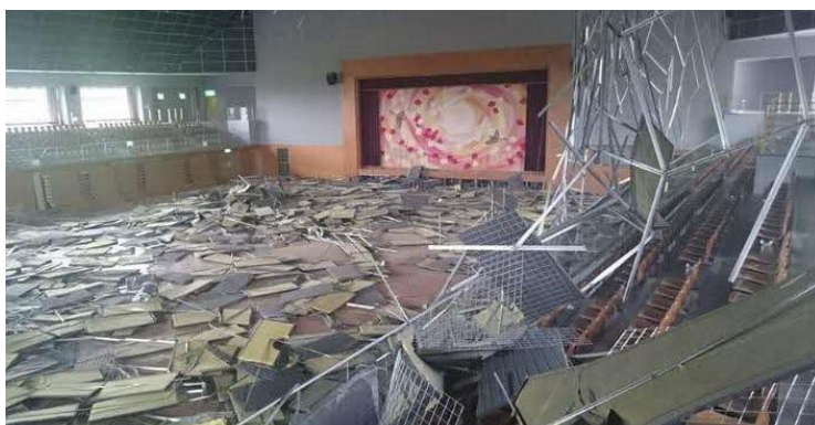
図 2 町有施設（総合体育館）の被害状況
