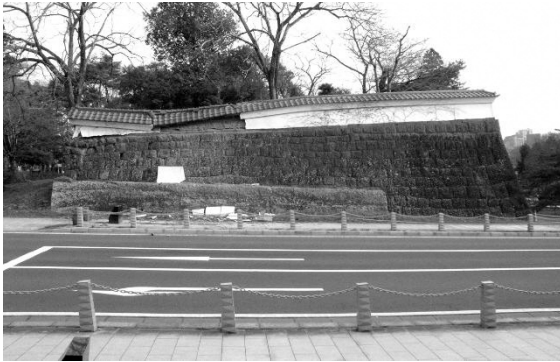
第 14 図 大手門北側土塀の被災状況 (1)
