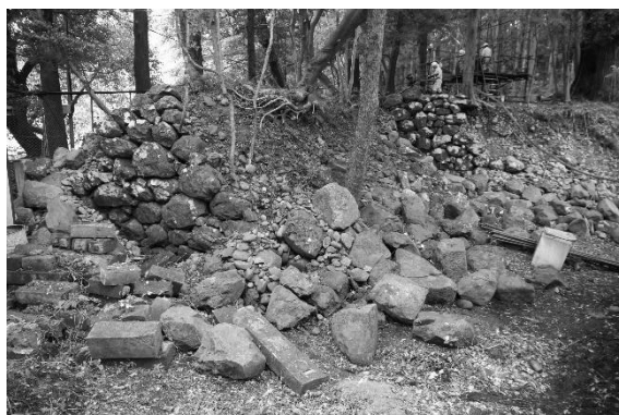
第10図 西門石垣の崩落状況
