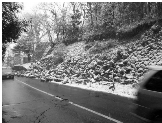
第9図 本丸北西石垣の崩落状況(2)
