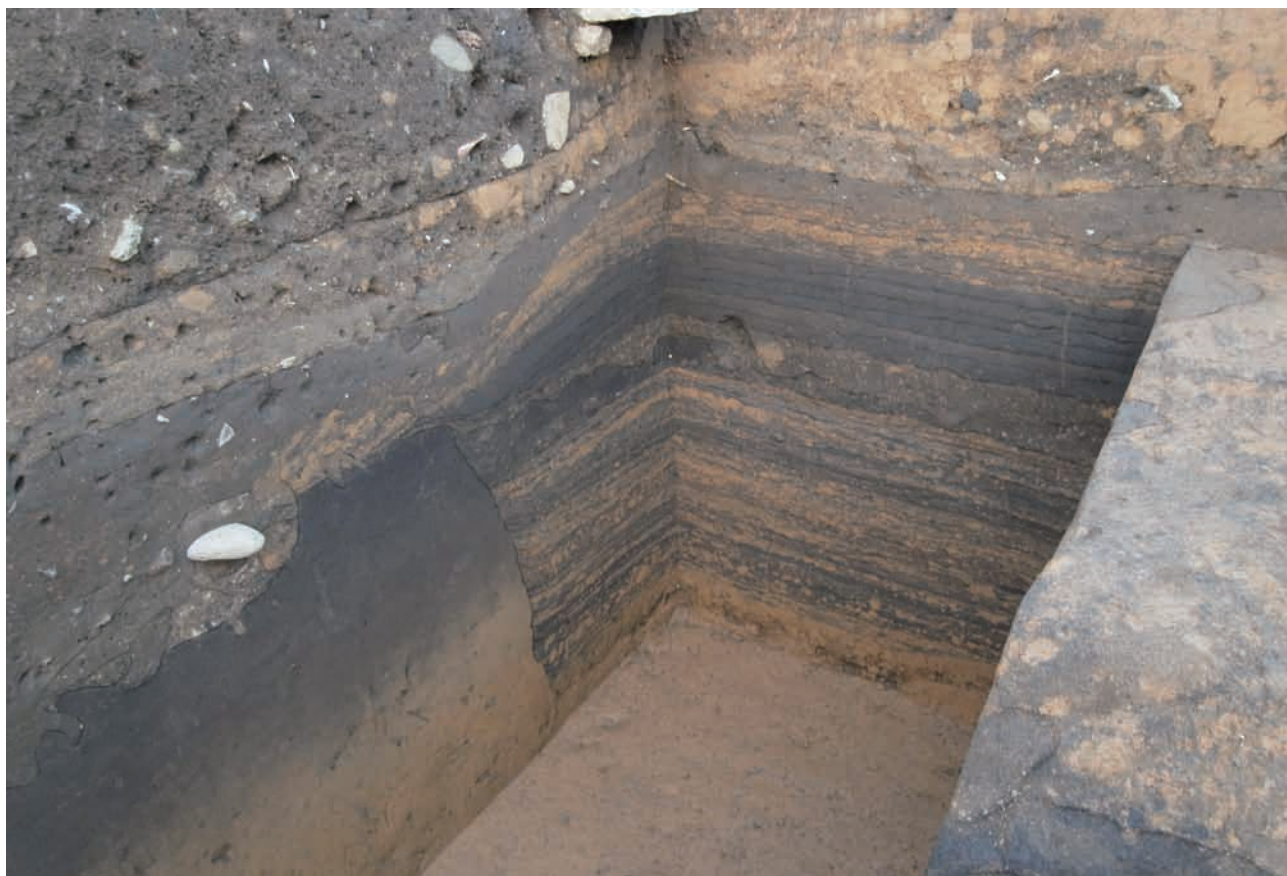
1 金堂4区旧トレンチ SB217 基壇・掘込地業版築断面（南西から）
