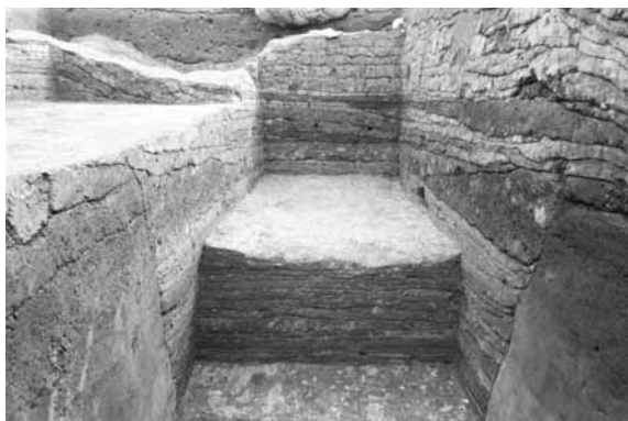
4 金堂6区旧トレンチ SB217 基壇・掘込地業 版築断面（北から）
