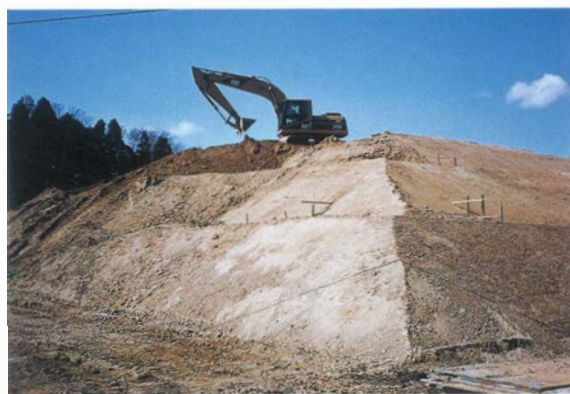
5 後方部造成状況
