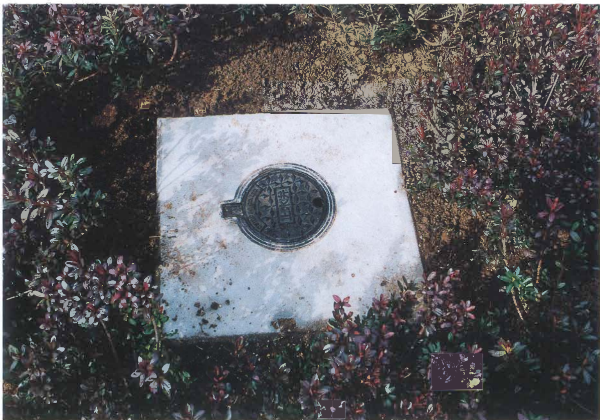
2 給水施設（上水栓）
