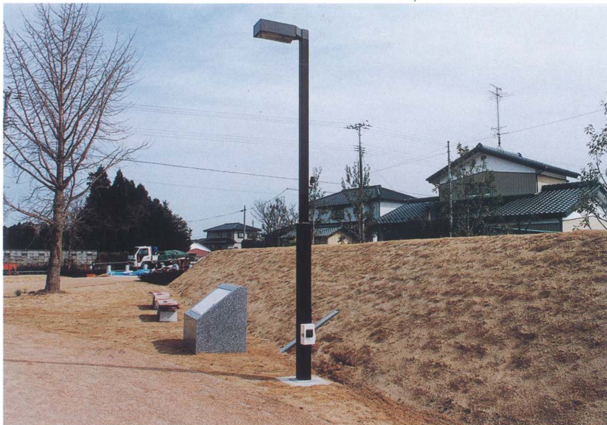
1 照明施設（防犯灯）
