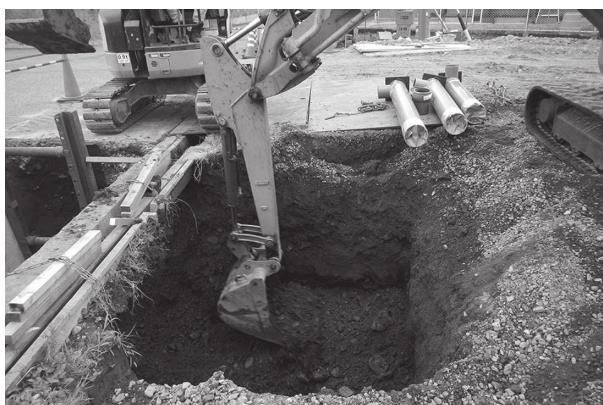
1 上下水道引き込み部 (西から)
