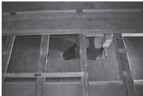
写真 174 諸役会所床下陥没箇所（東から）
