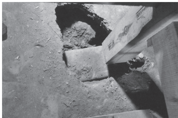
写真 175 諸役会所床下陥没状況（北から）
