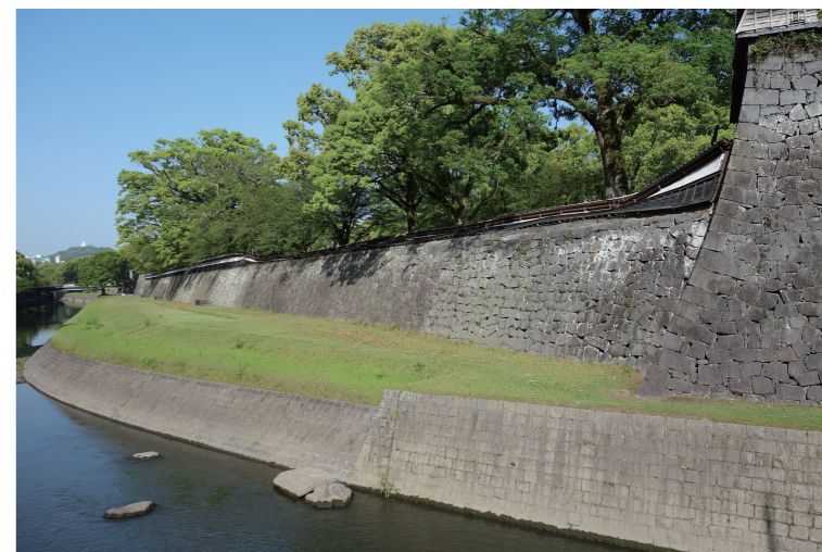
平成28年熊本地震で倒壊した長堀(南東から)
