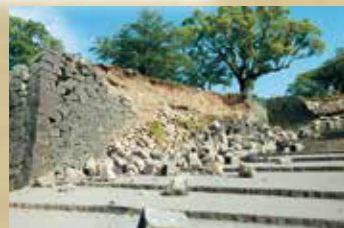
石垣崩落状況
