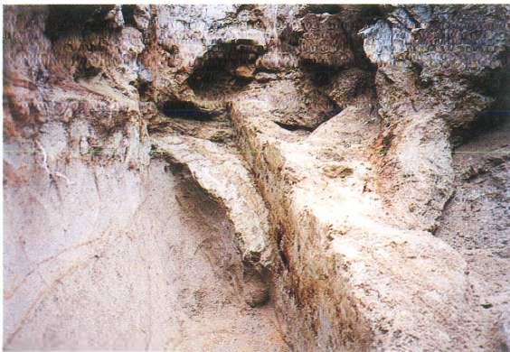
66 5号横穴墓 羨道部内岩盤崩落状況（南東から）
