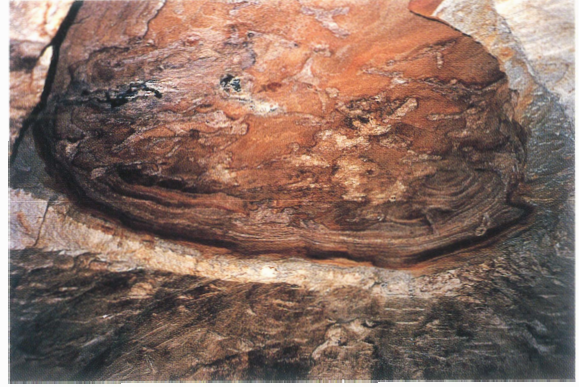
26 2号横穴墓 剥落した天井部（南から）
