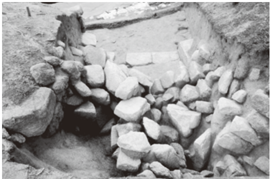
3. 側壁石材の崩落状況 (後方から)
