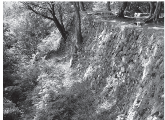
図60 石垣No.308から生える樹木
