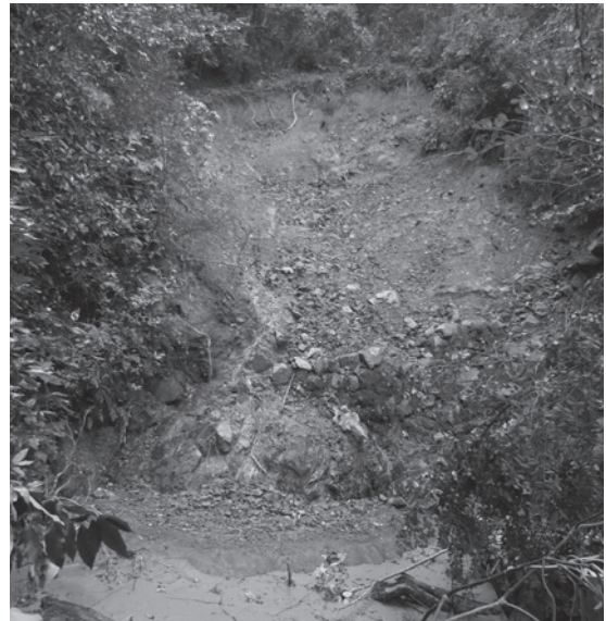
図84 被災後の雌池
