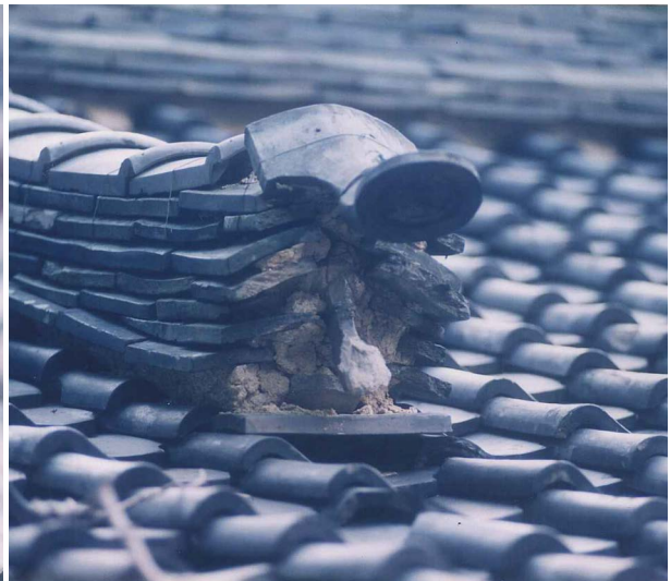
北東部降り棟先端の鬼瓦欠失部
