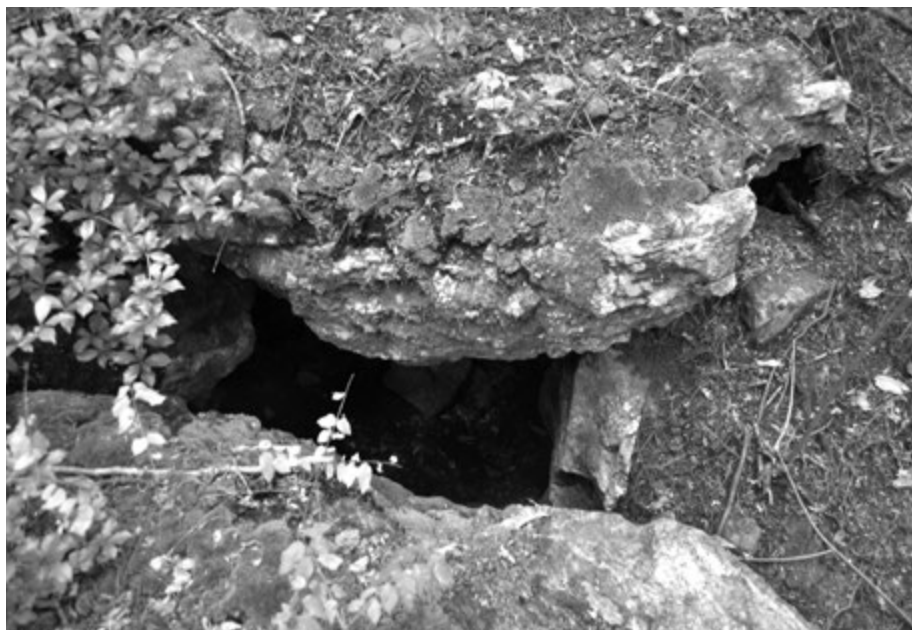
44 H12号墳 墳丘 前壁直上崩落状況
