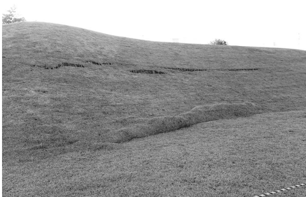
2. 令和元年台風19号の被害状況（南東から）
