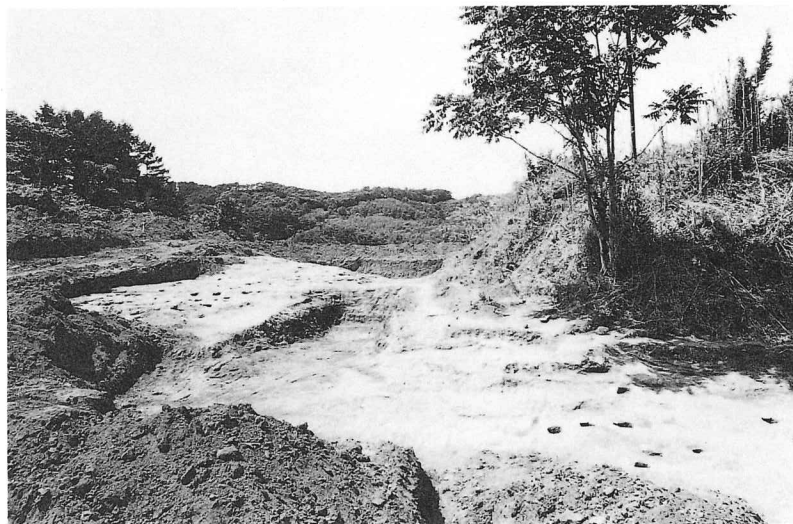
◀第5次調査区全景 (東から)
