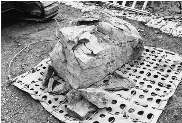
築石破損状況（角石）
