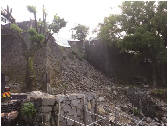
本丸石垣H416被災状況 北東から
