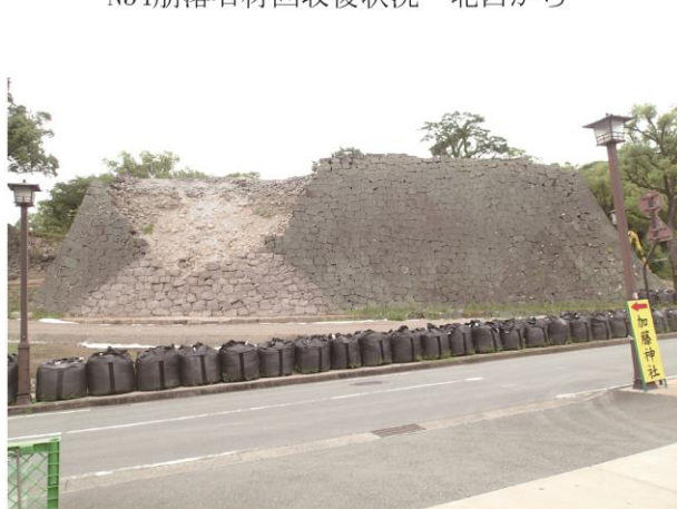
N35崩落石材回収後状況 北から
