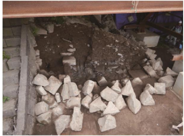
崩落石材検出状況 東から
