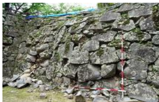
写真-1 孕み出しの様子 1)
