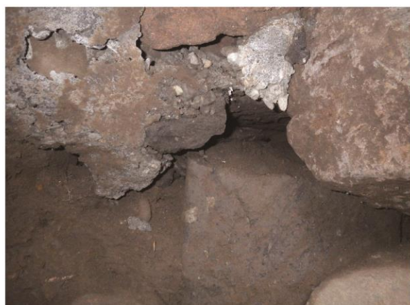
1-2トレンチ 控柱No.7破断部 東から
