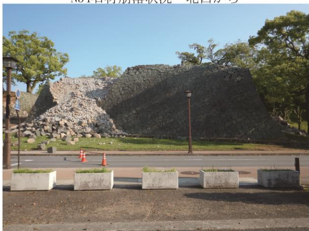
N35石材崩落状況 北から
