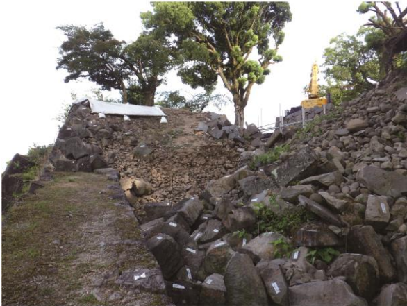
不開門虎口被災状況 北西から
