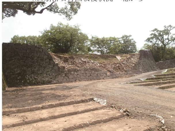
N48崩落石材回収後状況 北から
