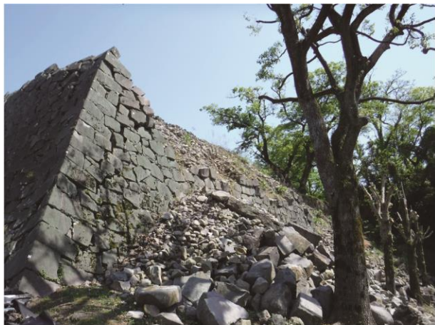
N34石材崩落状況 北西から
