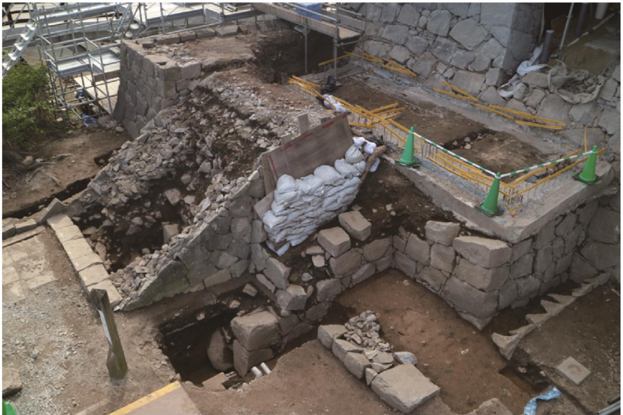
大天守附櫓周辺石垣解体後状況 北東から(江戸期の附櫓台石垣検出状況)
