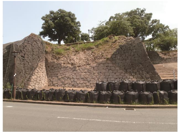
N50崩落石材回収後状況 北から
