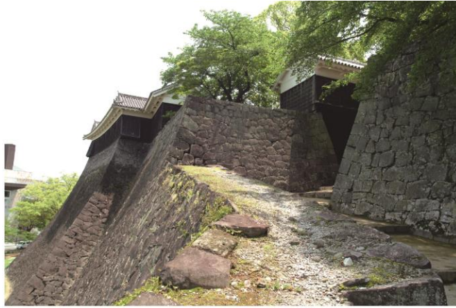
不開門虎口被災前状況 北西から
