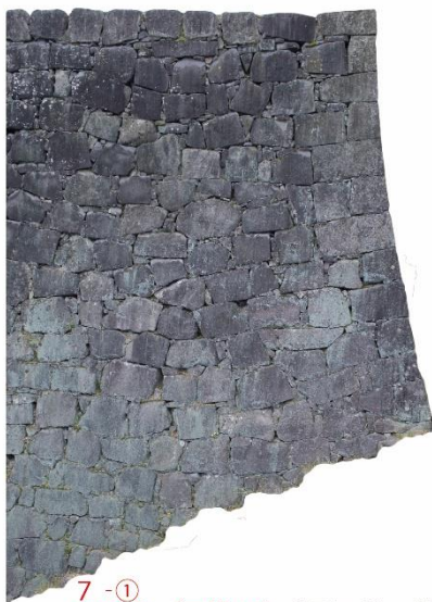
7-1 1702年（元禄15）方形石材で横目地通りやすい慶長後半期頃の石垣（方形石材で横目地通りやすい）に対して修復
