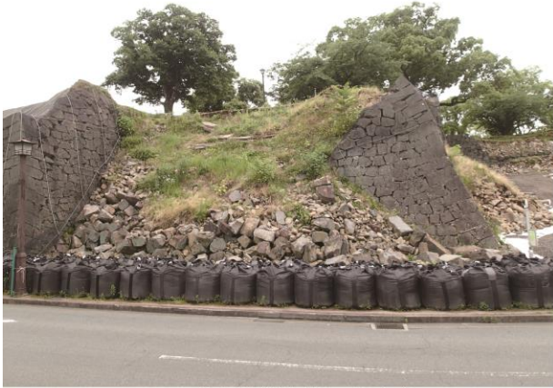
N50石材崩落状況 北から
