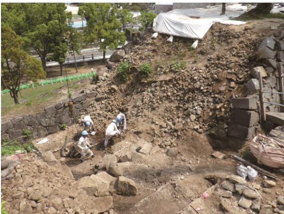
不開門虎口崩落グリ石回収状況 南から
