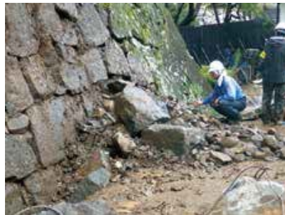
②崩落石材の番号付け
