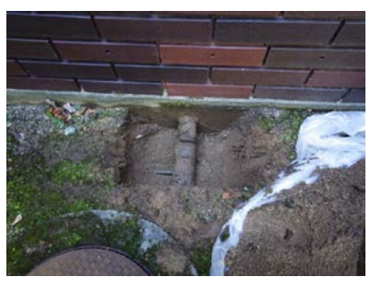
(11) ポイント2 ケーブル破損状況
