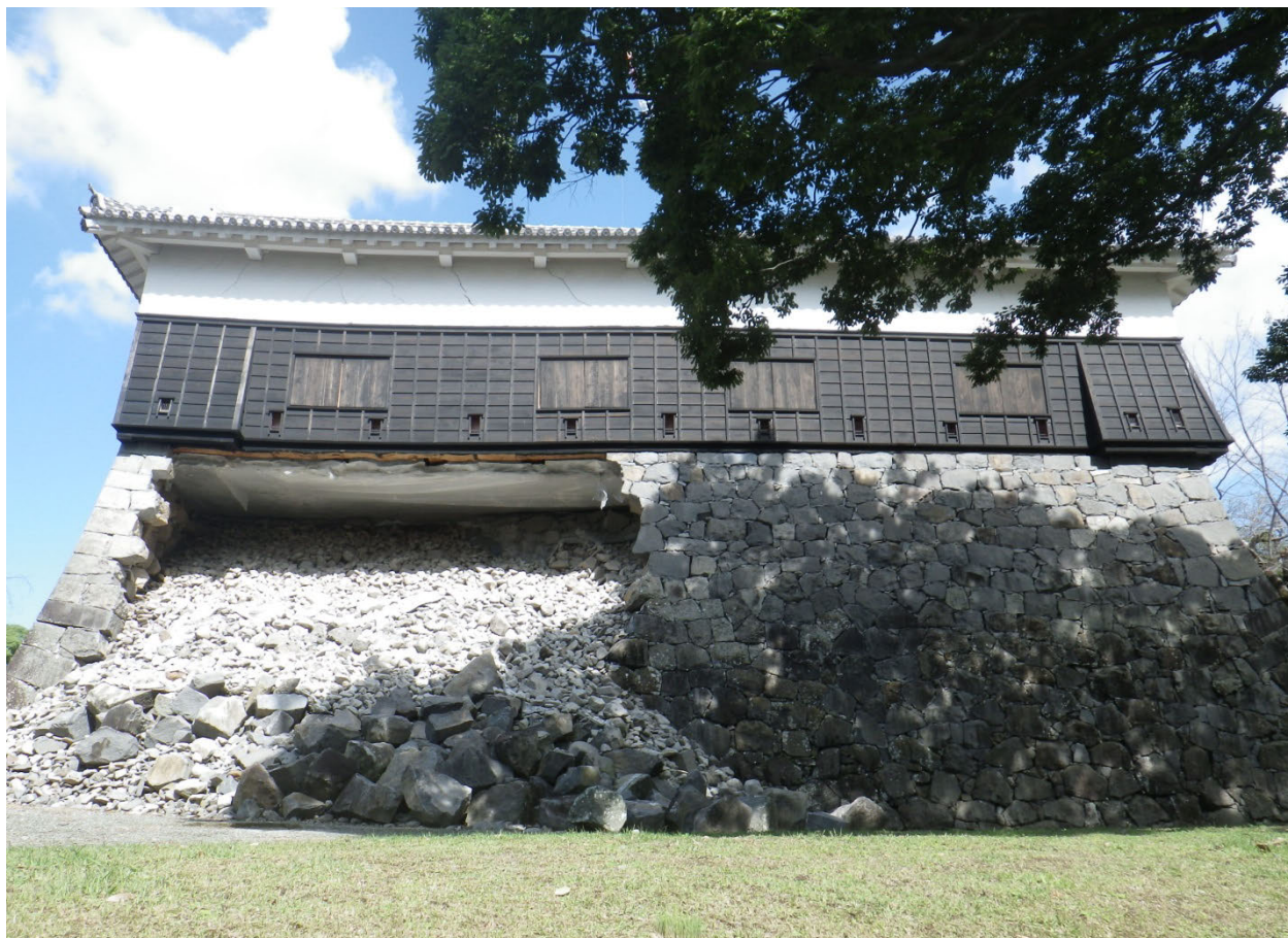
被災後 南から
