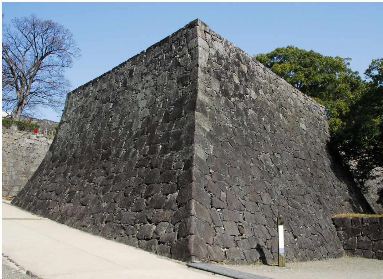
竹の丸五階櫓台石垣 被災前 南西から
