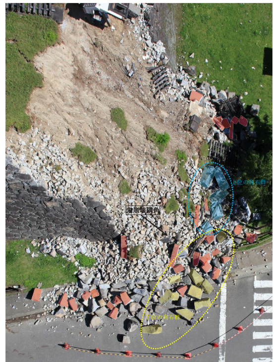
奉行丸南東隅崩落箇所の石材色分け 赤色は平成8年度修理で上位に積足した石材 無色は明治22年後の修理で下位に使用した石材
