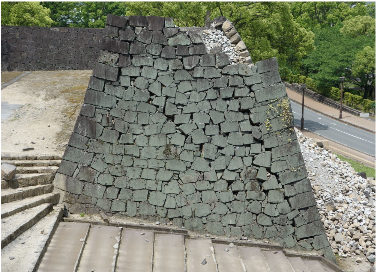
被災後 東から
