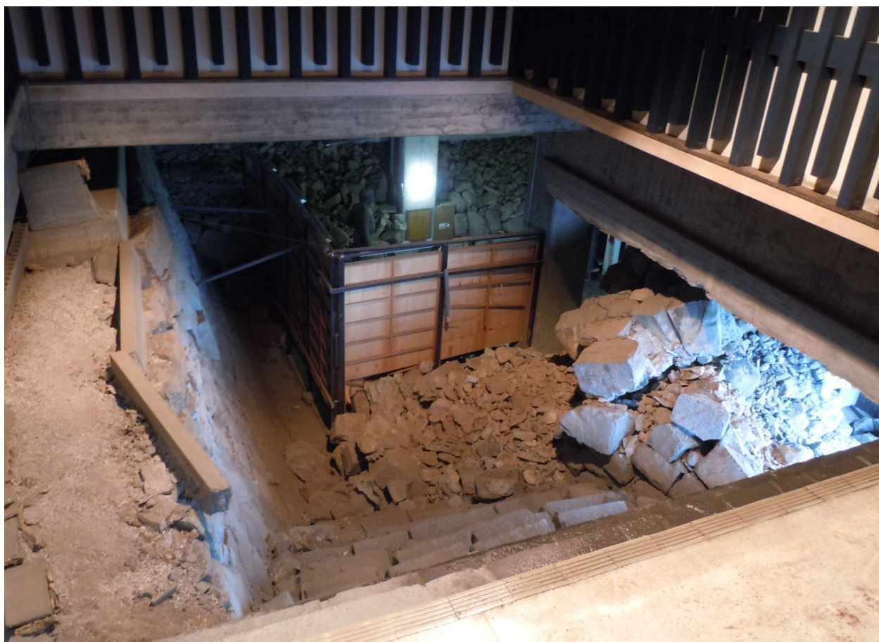
小天守穴蔵 被災後
