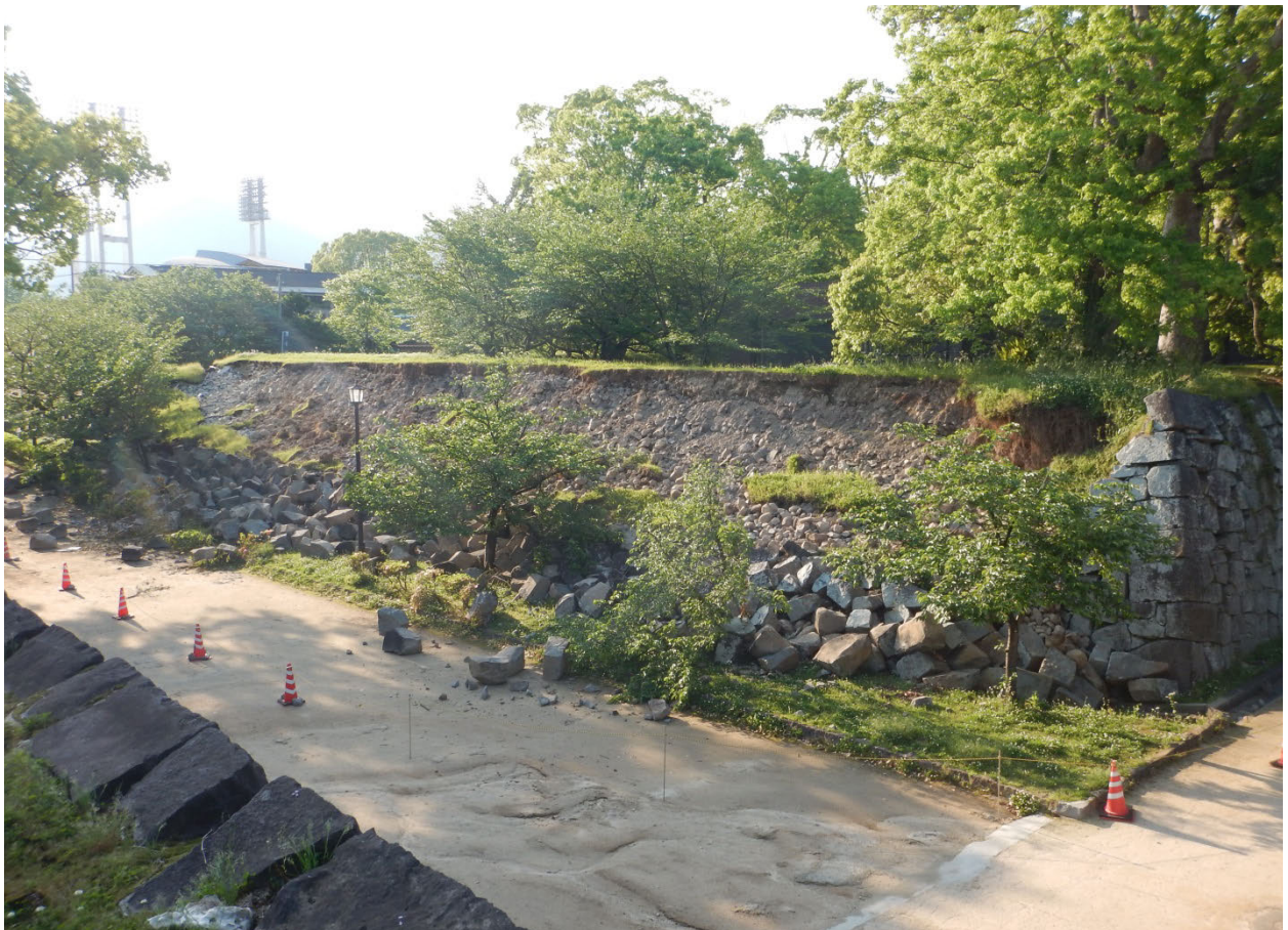
被災後 南東から
