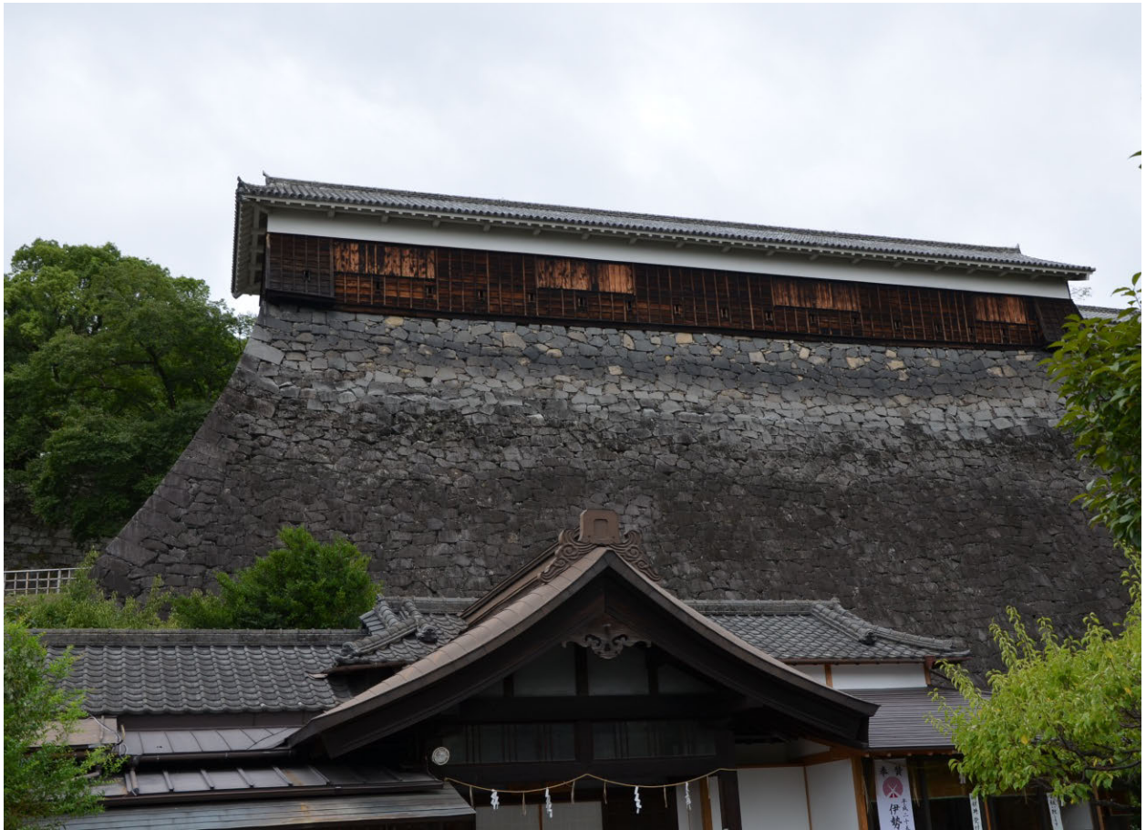
東十八間櫓東側石垣 被災前 東から
