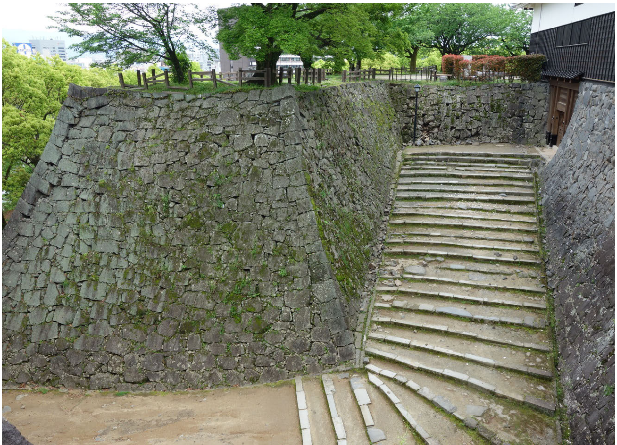
被災後 北から
