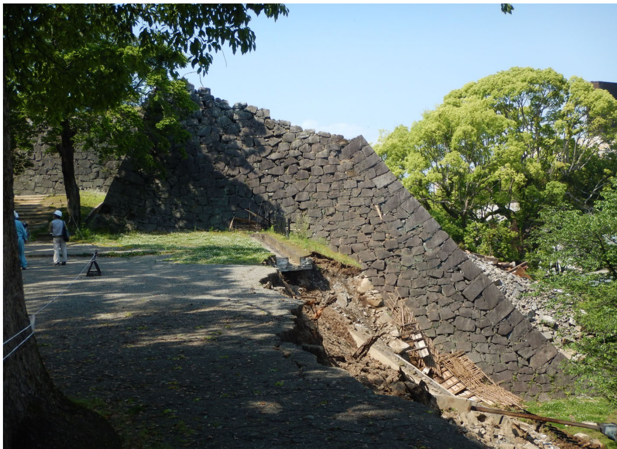
被災後 南から
