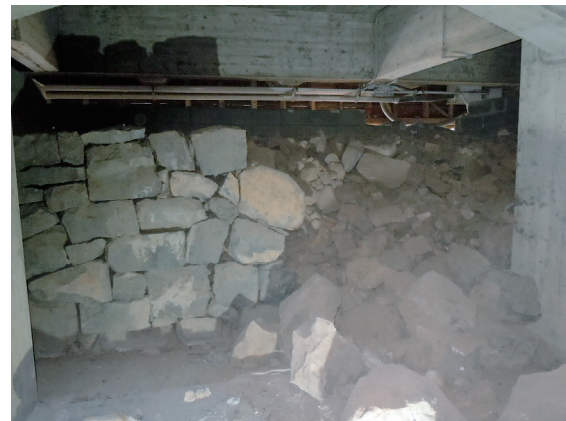
大天守穴蔵石材崩落状況
