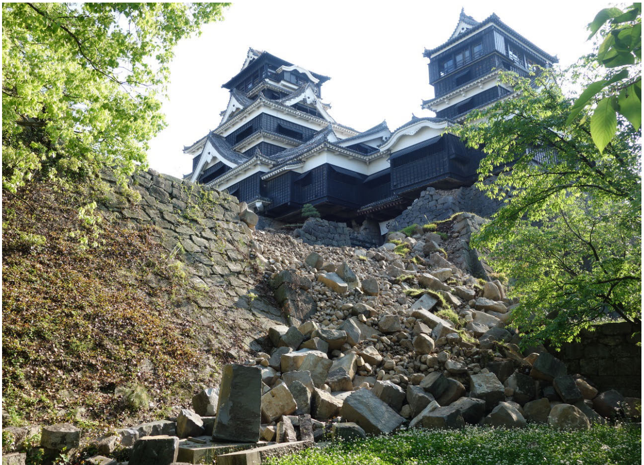
被災後 北東から
