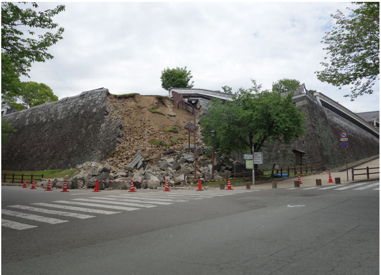
被災後 南東から
