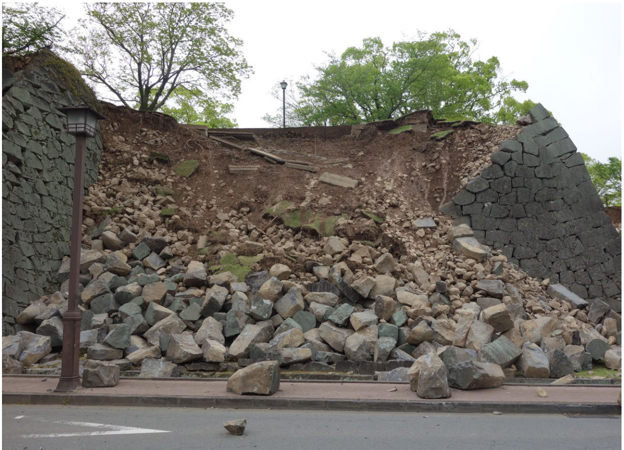
被災後 北から
