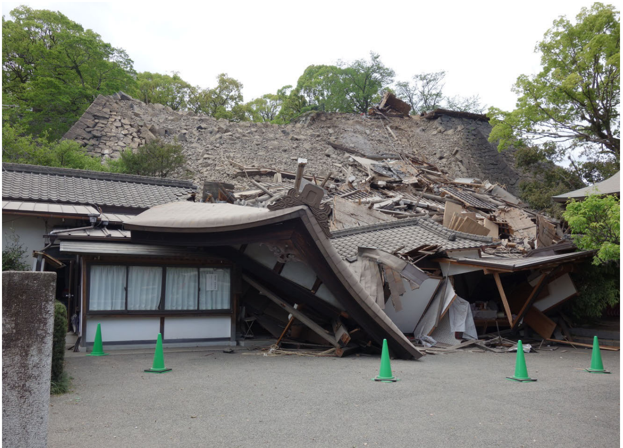
被災後 東から
