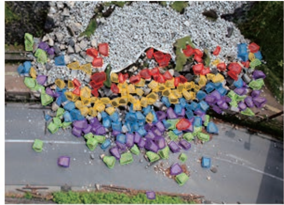
宮内橋際石垣崩落状況石材色分け
