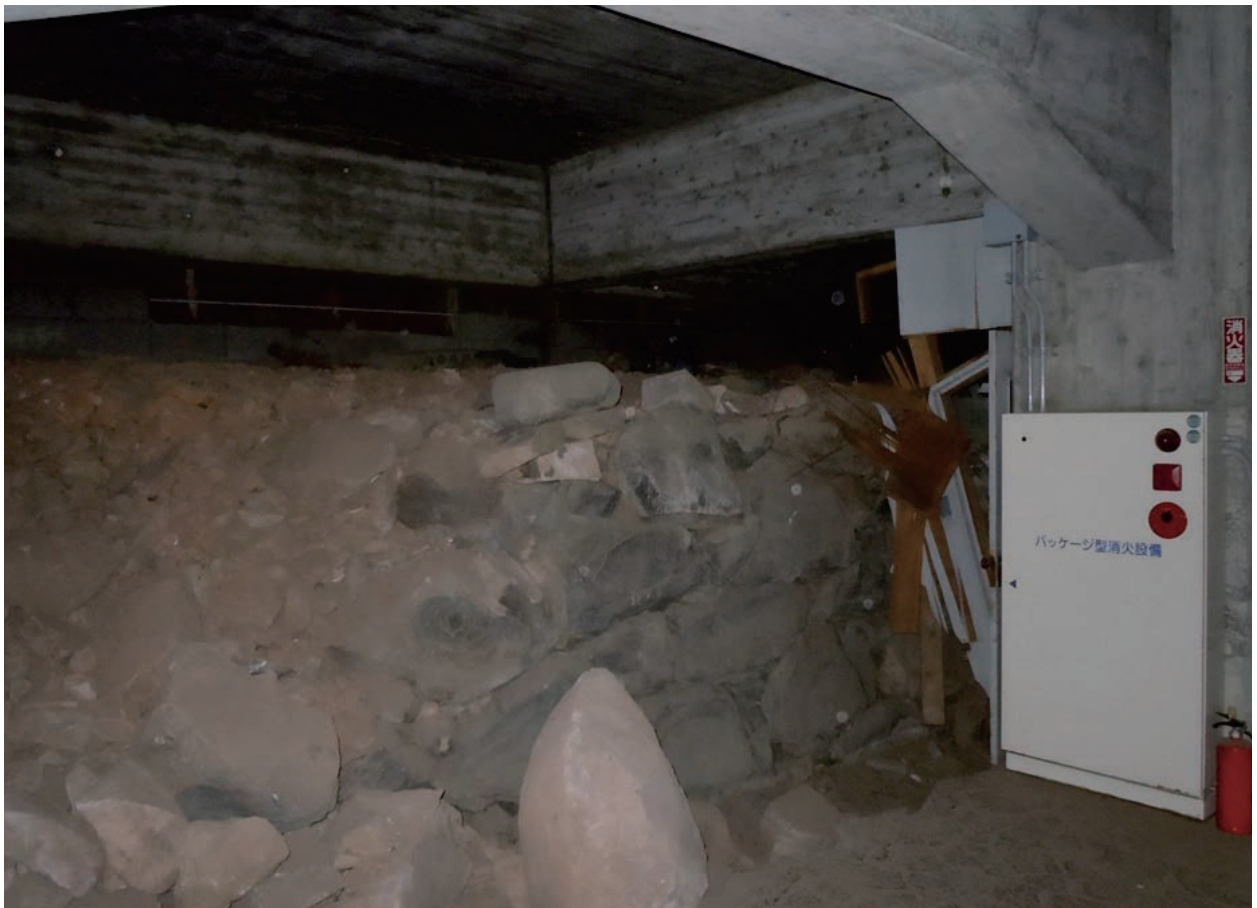
大天守穴蔵 被災後
