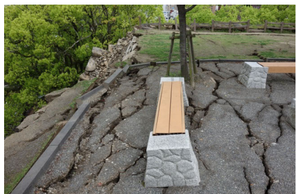
長局櫓北側石垣の崩壊と地割れ
