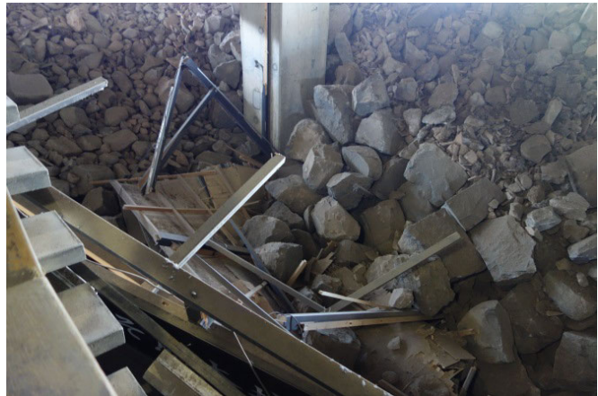
小天守穴蔵内部の被災状況
