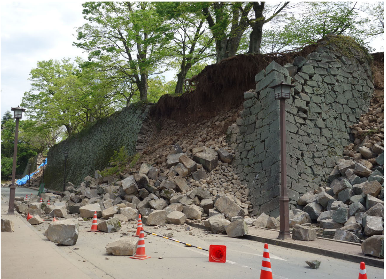
被災後 北西から
