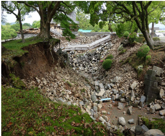
頼当御門口石垣崩壊状況
