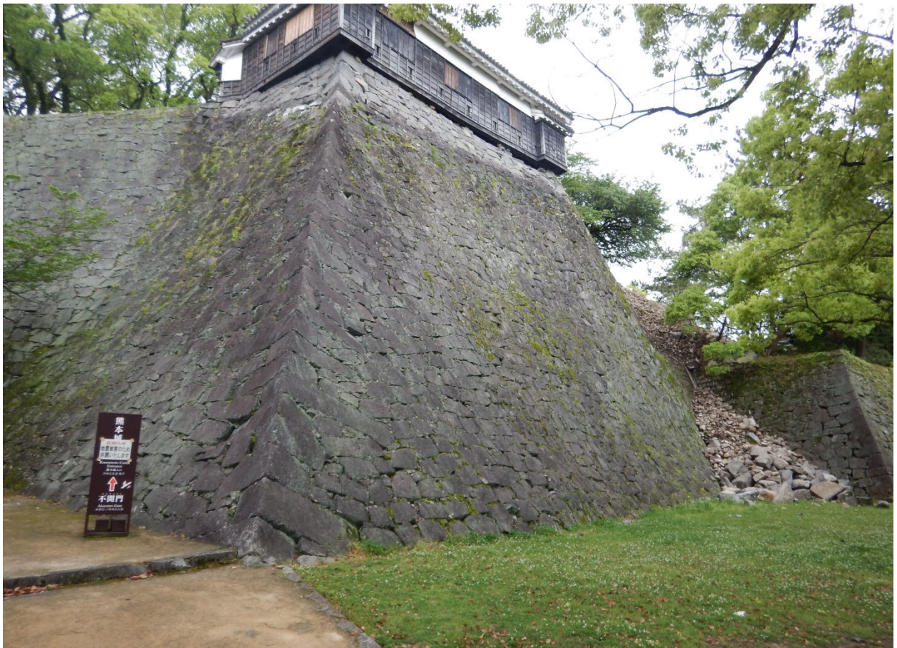
被災後 北東から
