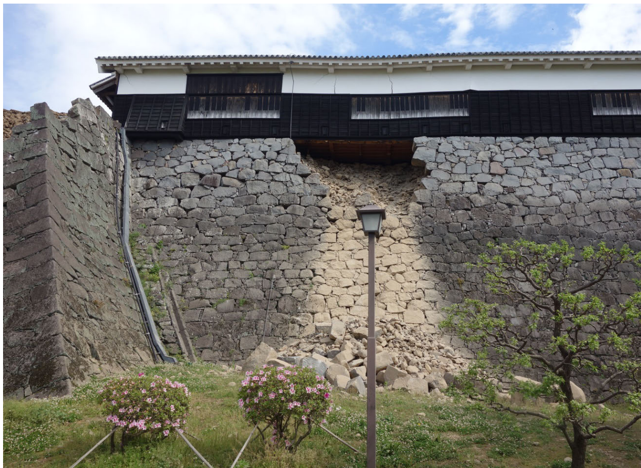
被災後 南から
