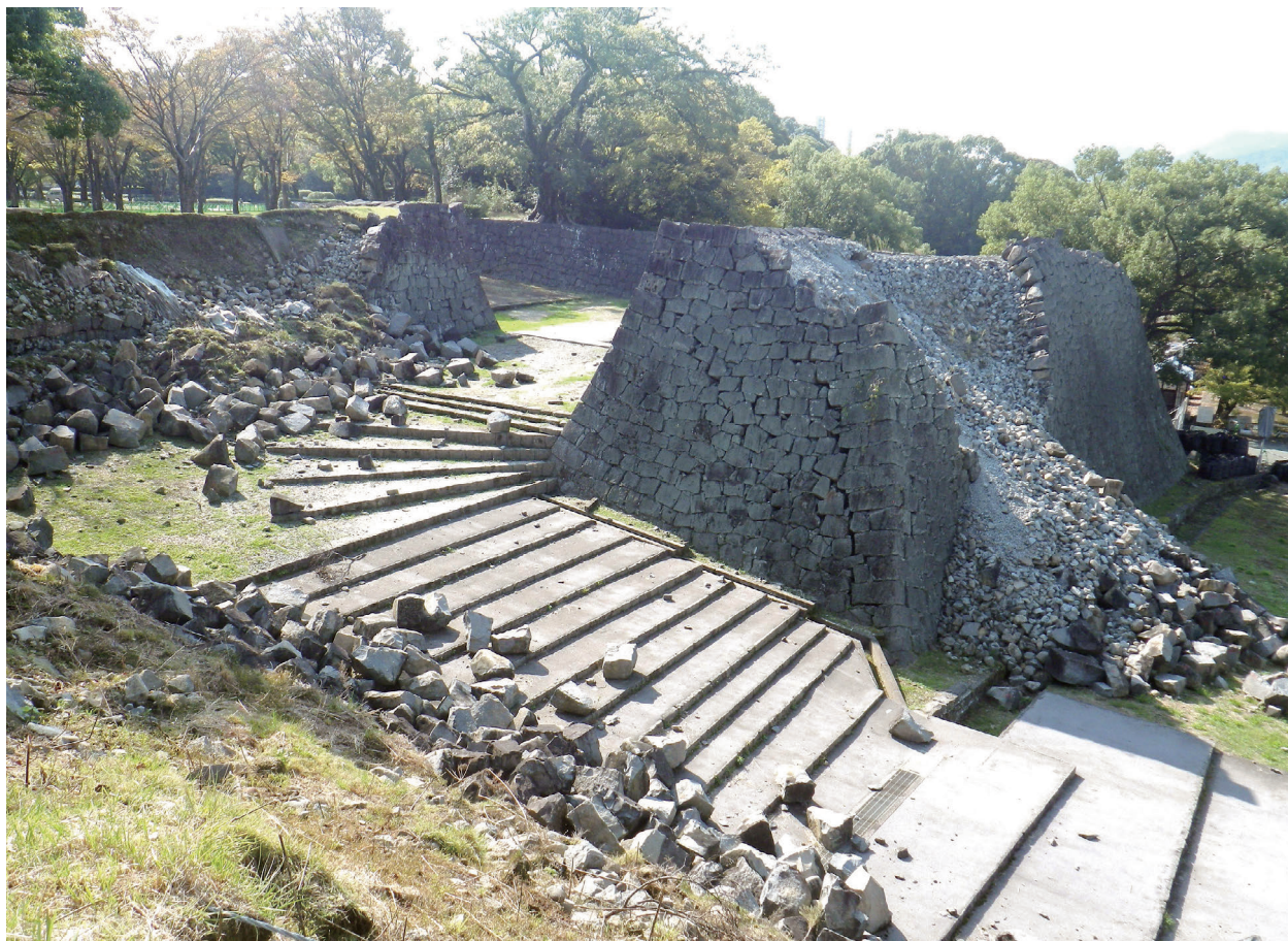
被災後 北東から
