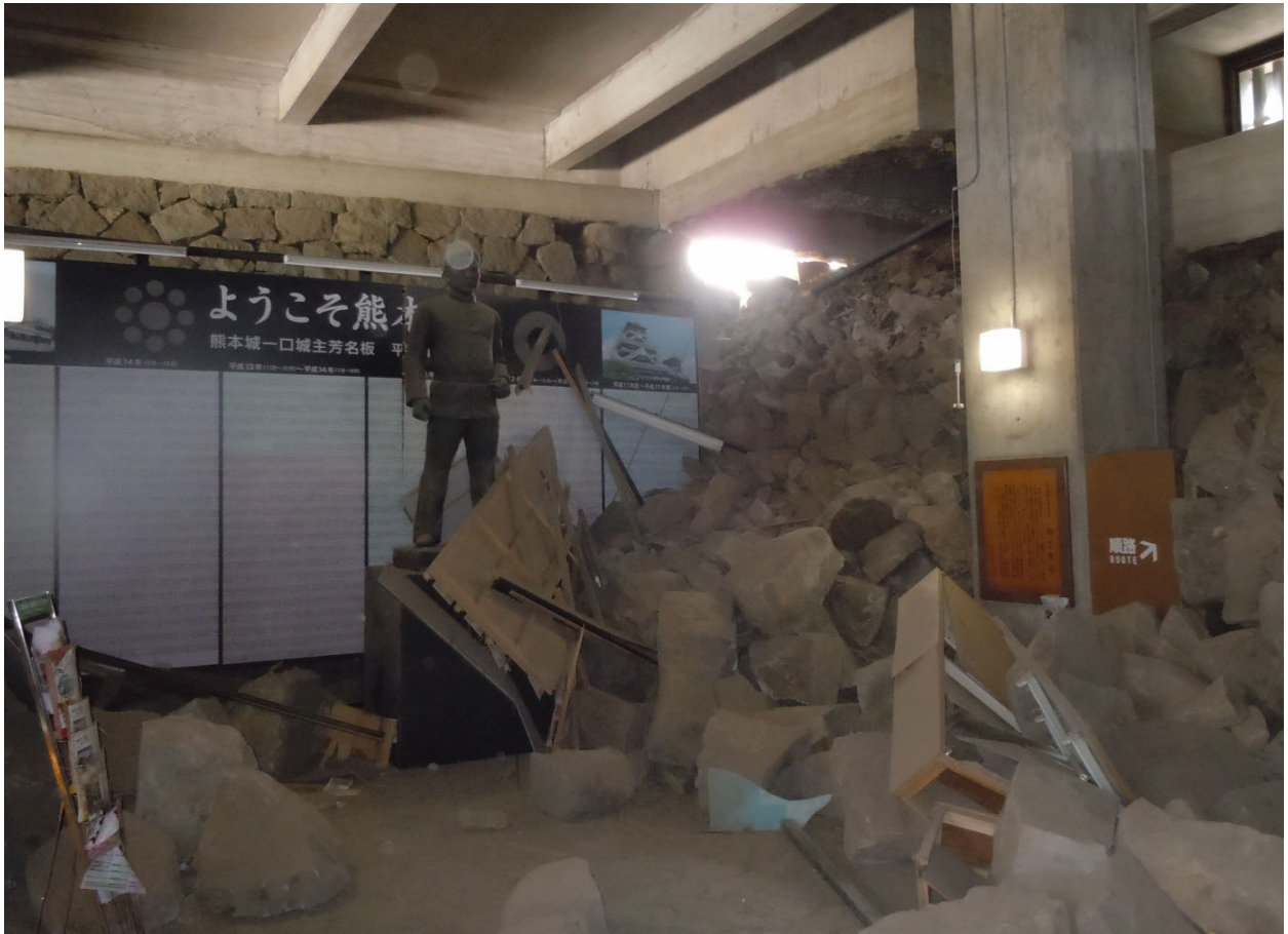
小天守穴蔵 被災後
