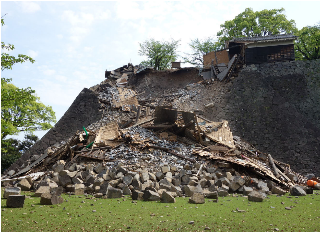
被災後 北から
