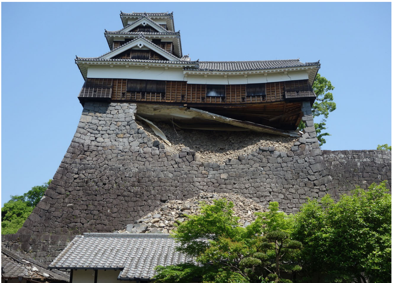
被災後 南から
