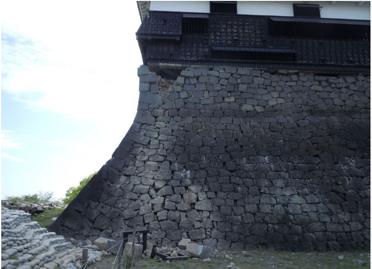
小天守北西石垣 被災後 西から
