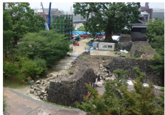
西櫓御門後石垣崩壊状況
