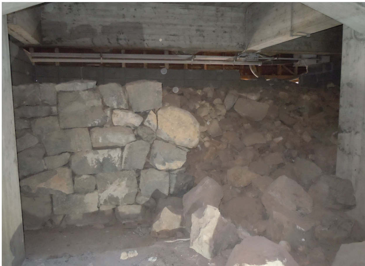
大天守穴蔵 被災後
