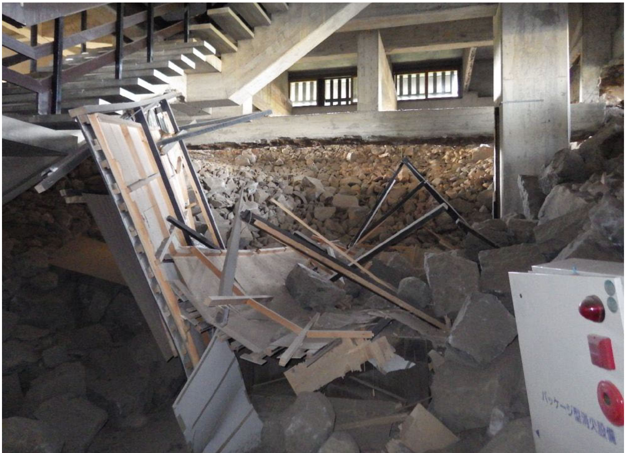
小天守穴蔵 被災後
