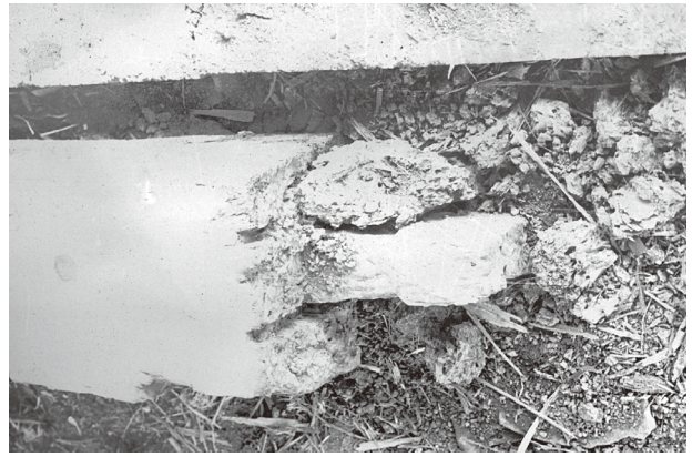
図 6-76 継手の蟻害状況
