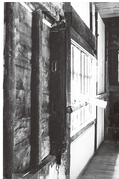
図6-12 要旨三(イ) 2 続櫓西側、北より第三間北寄り柱(もと窓の痕跡)。文化庁所蔵。
