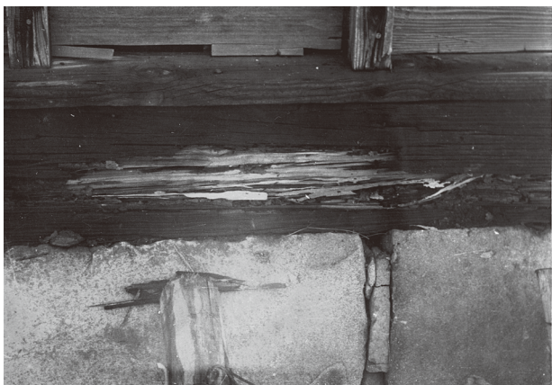
図 6-36 続櫓土台腐朽
