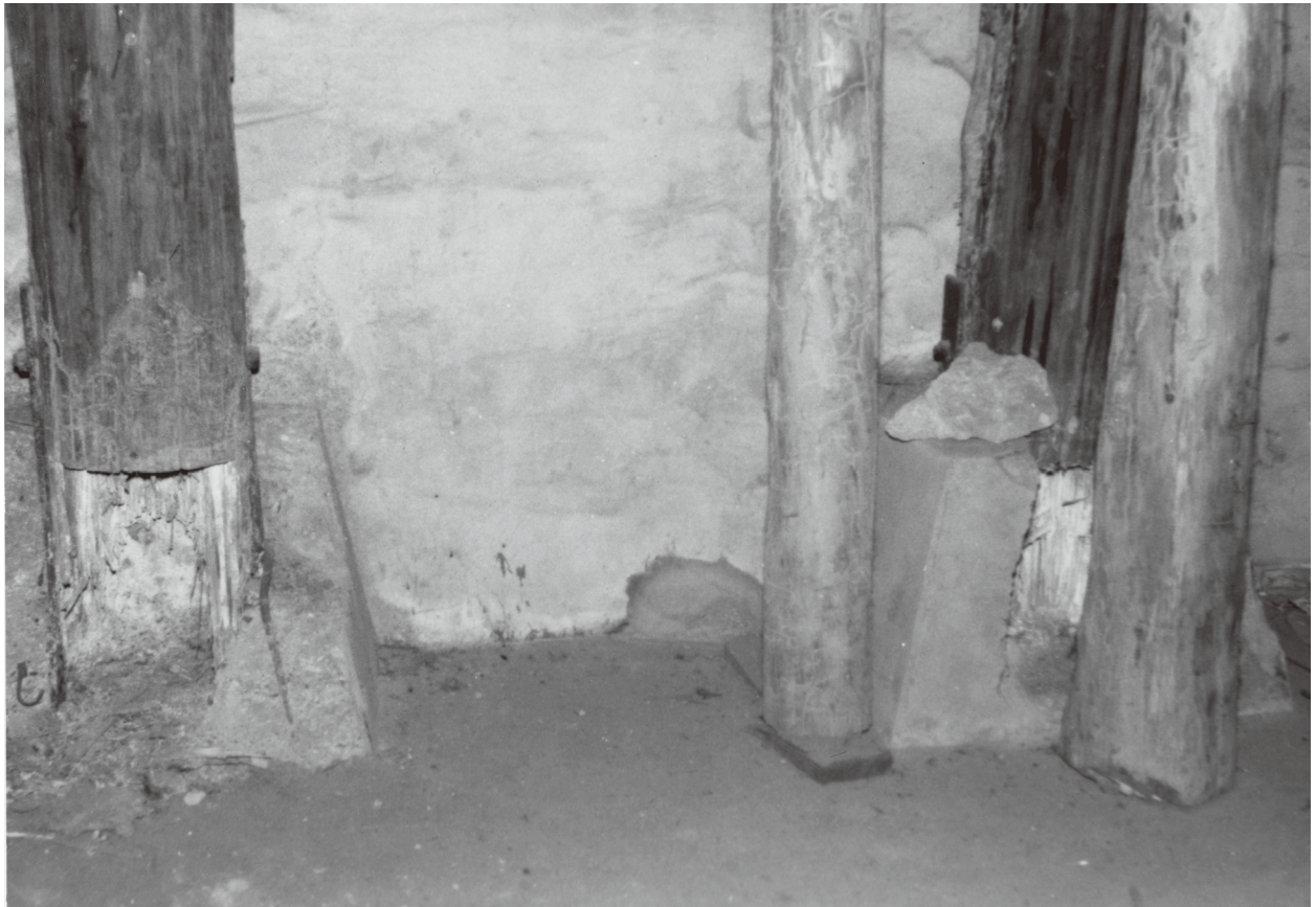
図 6-85 地階柱足下の蟻害状況
