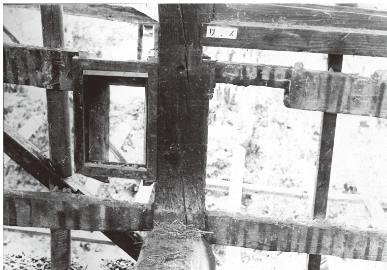
図 6-30 要旨二（口） 続櫓腰貫に残る旧銃眼欠 3 図 6-29 の壁を撤去した状態。文化庁 所蔵。
