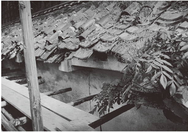
図 6-32 屋根の破損状況
