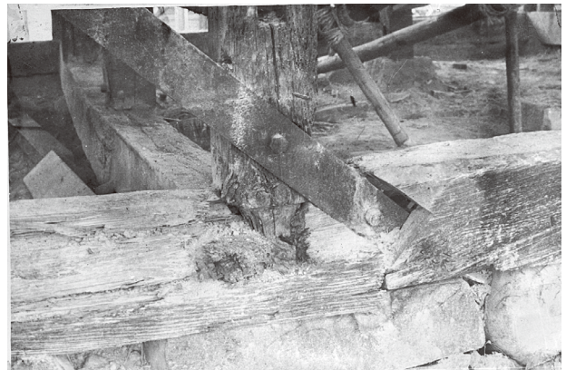
図 6-78 鉄製筋違端部の破損状況
