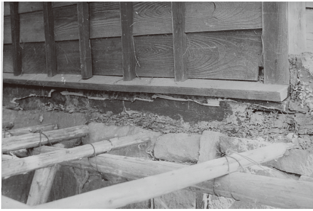
図 6-75 続櫓南東隅 土台の腐蝕☆
