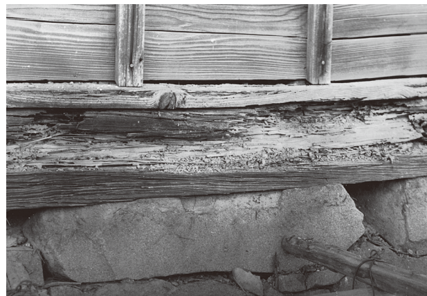
図 6-35 続櫓西側土台腐蝕（位置図 1・2 カ ）
