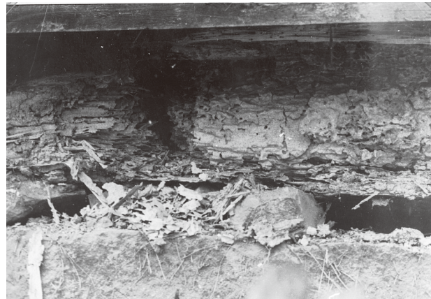
図 6-34 続櫓東側土台腐蝕（位置図 4・5 カ ）
