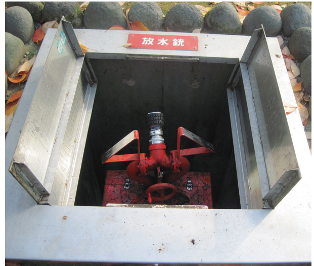
図 5-15 地下式放水銃内部（竹の丸）
