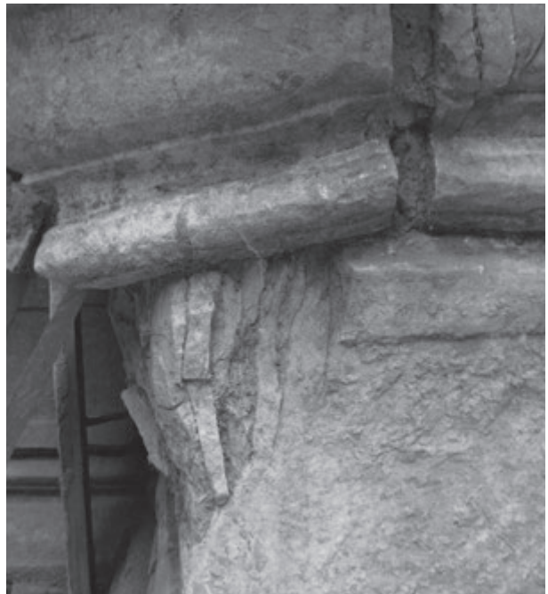
第39図 羽目石の破損状況
