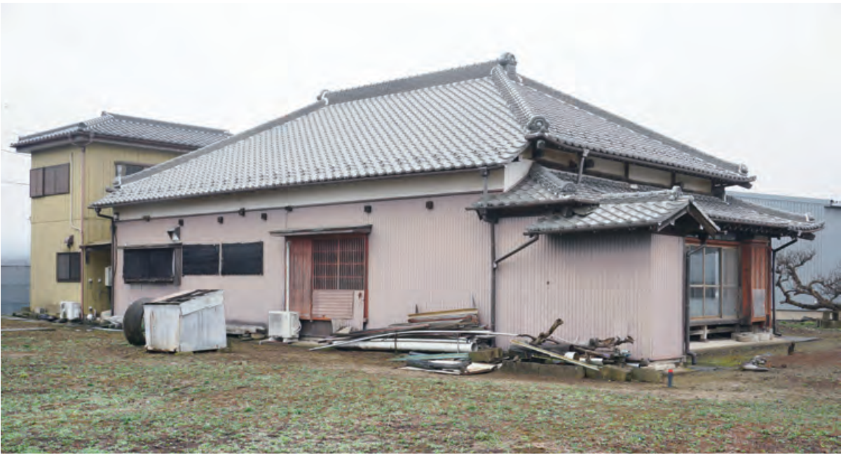
背面 南西から見る。壁上方には小屋組の梁小口が出ている。
