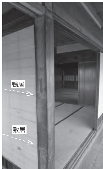
③ 式台玄関戸袋内側の壁の痕跡 (南面)。②に対となる痕跡
