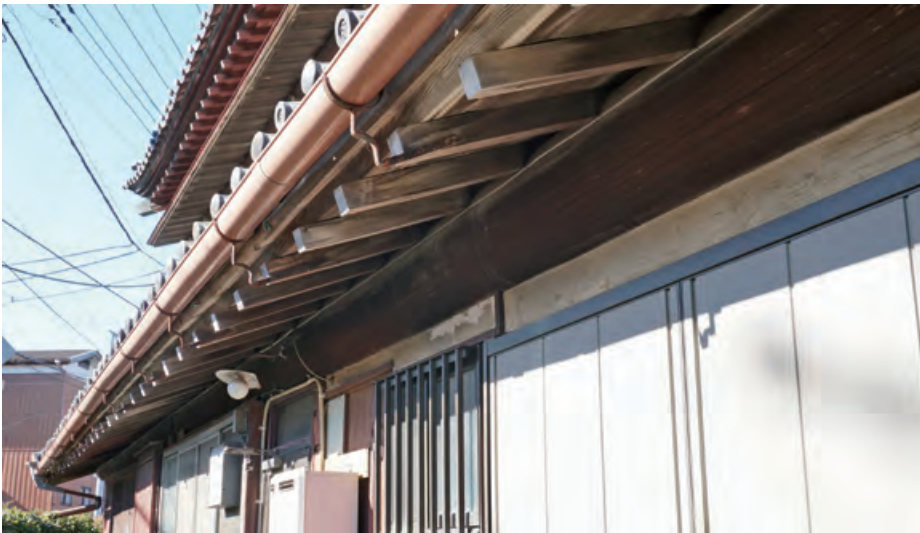
茨城より入手した、下屋全長に及ぶ一材からなる杉丸太の桁
