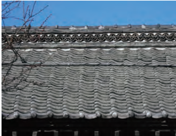
棧瓦葺の屋根 大棟は丸瓦を輪違いに積み、模様をつくる。
