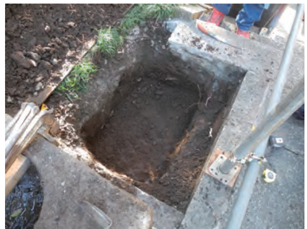
4 根石の下に地業はなく、地山となる「はに」土の上に直にのる。周囲の樹木の根が育って根石の下に入り込み、石は約30ミリ持ち上げられていた。
