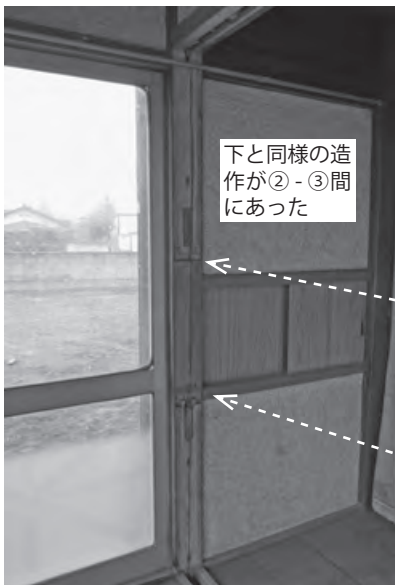
② 式台玄関戸袋内側の壁の痕跡 (南壁北面)
