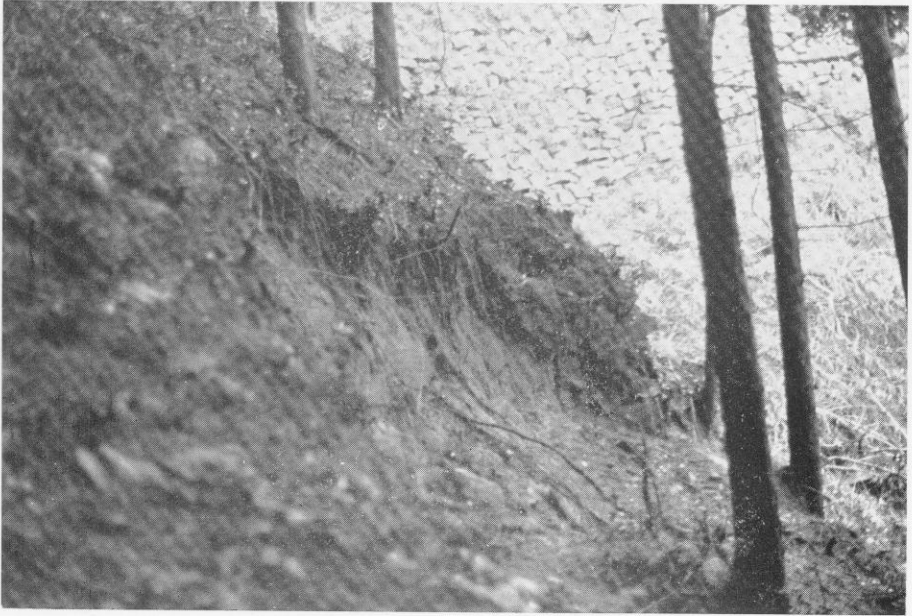
図版14 百間石垣崩壊箇所
