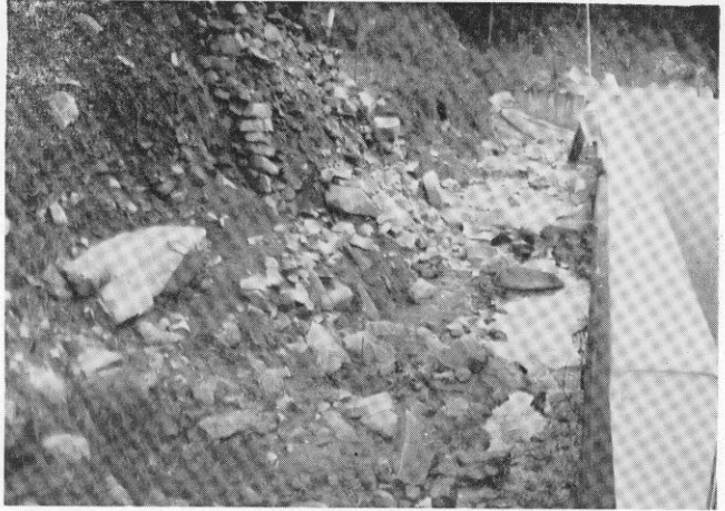
図版2 (I. 百間石垣端部崩壊直後)
